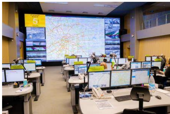
Figura 1.2. Centro de Control de un Sistema de Semáforos Integrado [3]
