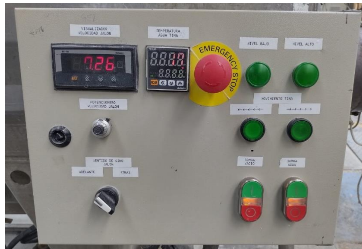
Figura 2.14. Tablero de control de maniobras de tina de vacío y enfriamiento
