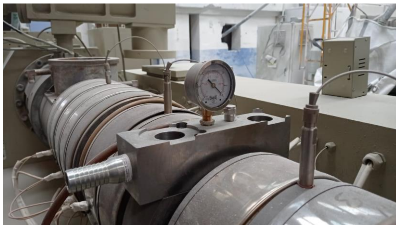
Figura 1.4. Zona de desgasificación del barril de extrusión
