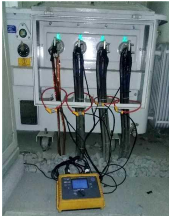
Figura 11 – Conexión del analizador de redes en el lado de baja tensión del transformador que alimenta el edificio de relación con el medio externo. Fuente: (Fabricio et al. 2021).
