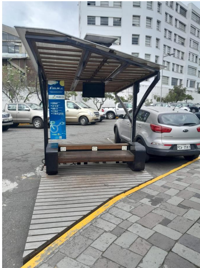
Figura 3 Sistema de generación fotovoltaica instalado en el parqueadero de la Facultad de Ingeniería Eléctrica y Electrónica. Fuente: Elaboración propia.
