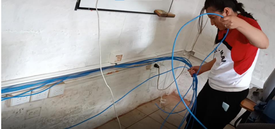
Figura 3.17 Canalización en el laboratorio
