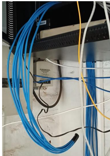
Figura 3.16 Ingreso de los 8 cables en el rack
