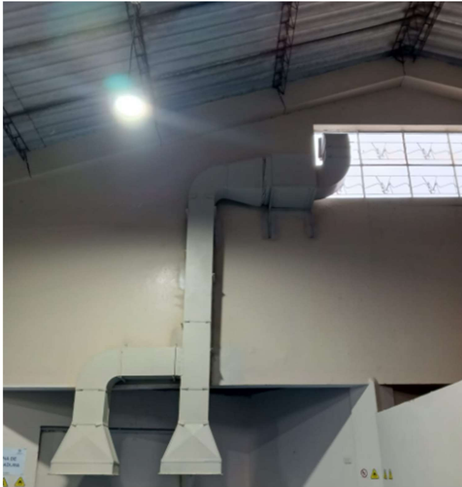
Figura 3.1 Vista frontal del sistema instalado
