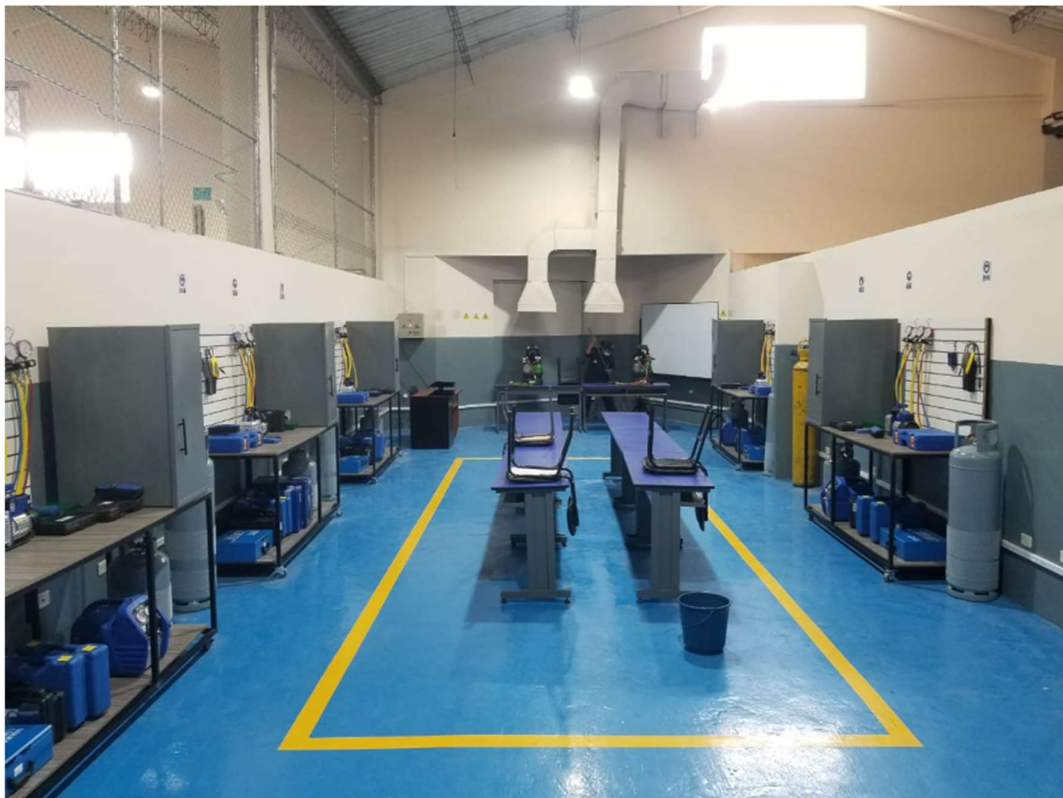
Figura 3.3 Vista del sistema instalado en el centro de perfeccionamiento para el manejo de refrigerantes naturales
