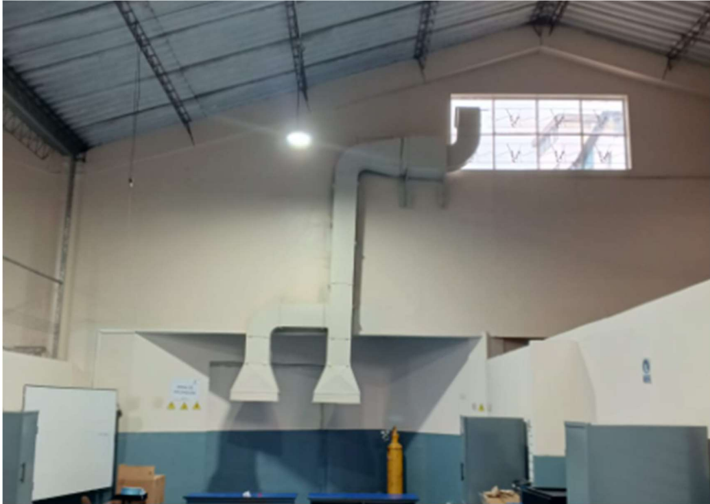
Figura 3.2 Vista frontal del sistema instalado
