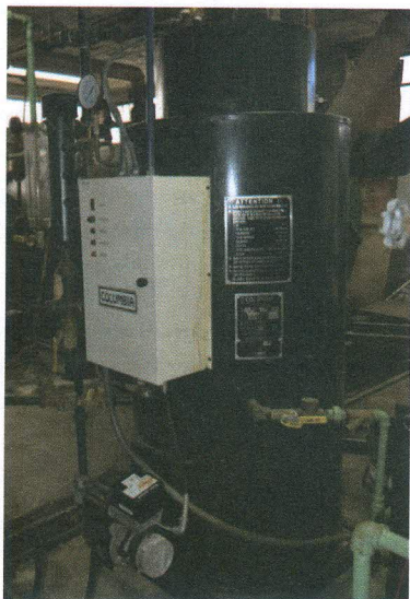
Fig. 1 Caldero Columbia CT-6 de la planta piloto
