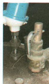
Fig. 10. Válvula de Seguridad
