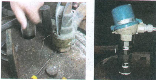
Fig. 5. RTD colocado en el caldero
