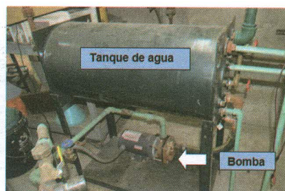
Fig. 11. Bomba de agua con el tanque de almacenamiento de agua.
