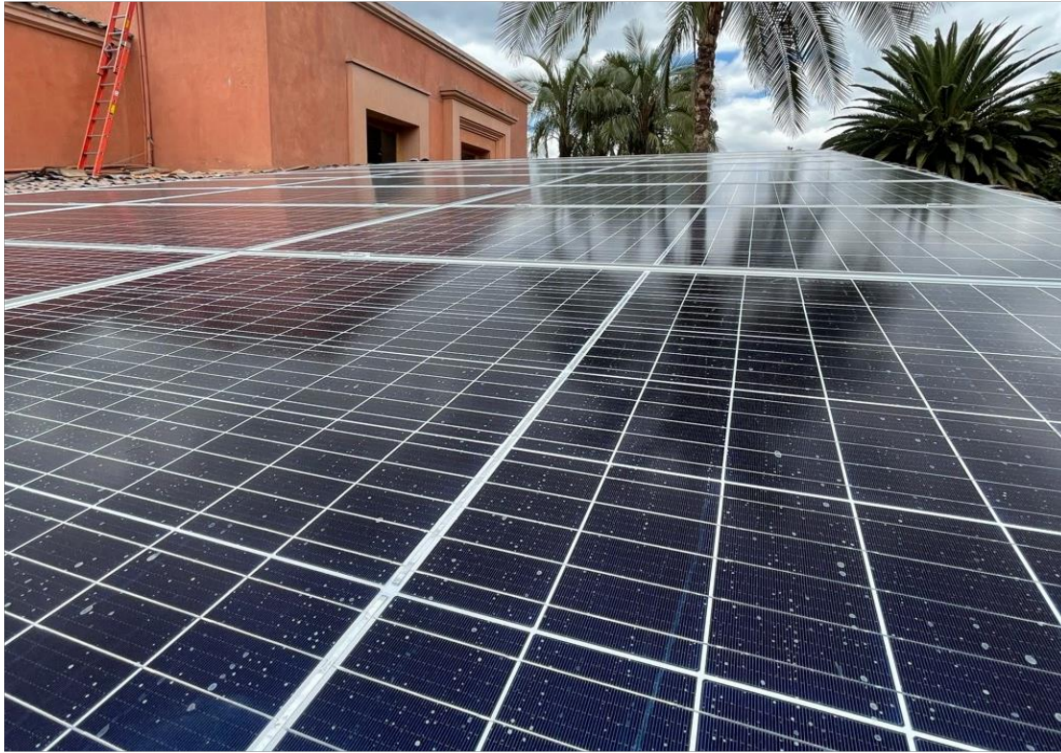
Figura 3.10. Paneles fotovoltaicos sobre cubierta con inclinación de 9° [Elaboración Propia].
