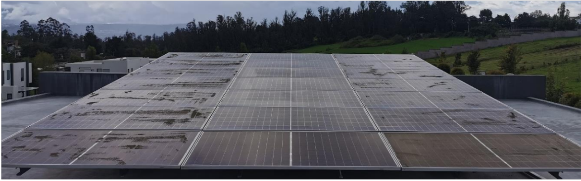
Figura 3.5. Central fotovoltaica 1, escenarios de suciedad [Elaboración Propia].
