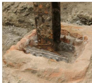
Figura 1. 3 Corrosión de Cimentación de acero.
