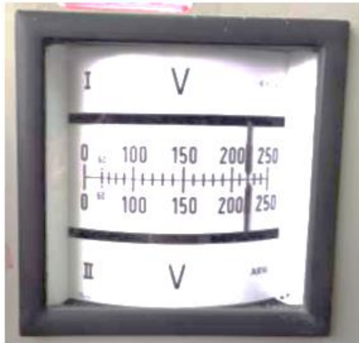
Figura 3.38. Nivel de voltaje de la red y del generador.
