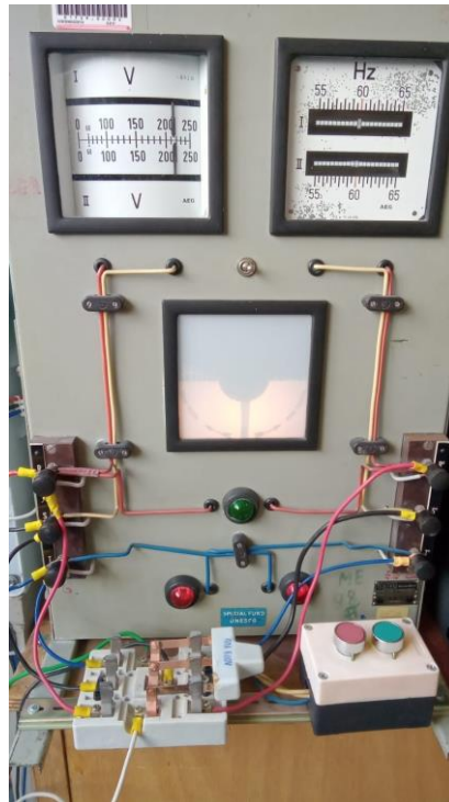
Figura 3.40. Módulo del sincronoscopio operando en paralelo.
