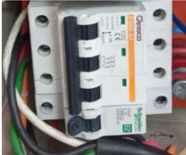
Figura 3.32. Breaker principal para la alimentación del módulo GOV.
