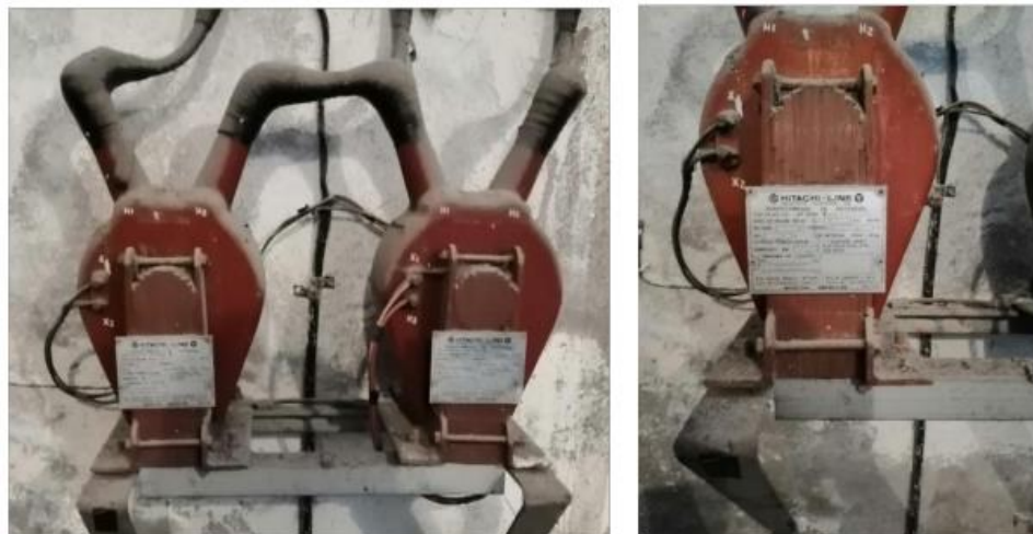
Figura 1.3. Transformadores de potencial.
