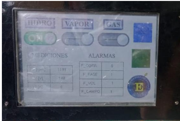
Figura 3.29. Estado de las protecciones.
