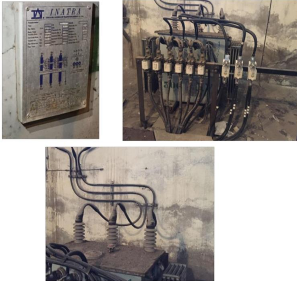
Figura 1.2. Transformador de la red de la EEQ.
