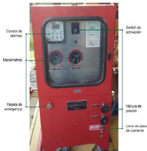
Figura 12. Tablero Murphy (Escuela de operaciones SERTECPET, 2011).
