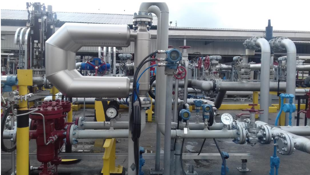
Figura 3.3. Medidor de Coriolis del ramal frontal 13-A.
