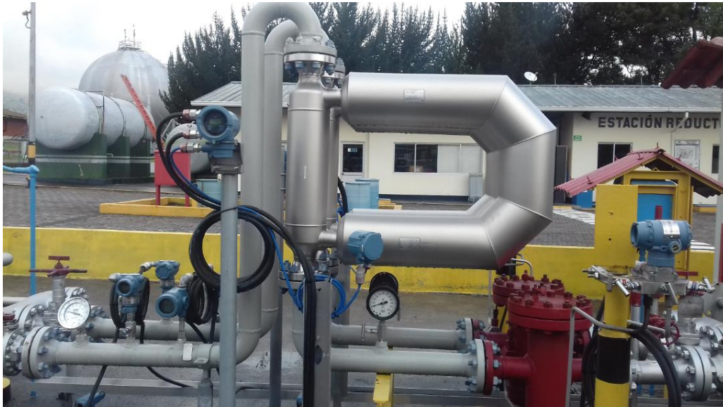
Figura 3.4. Medidor de Coriolis del ramal posterior 12-A.
