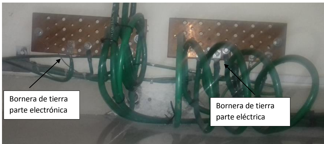
Figura 3.7. Borneras del mallado de puesta a tierra.
