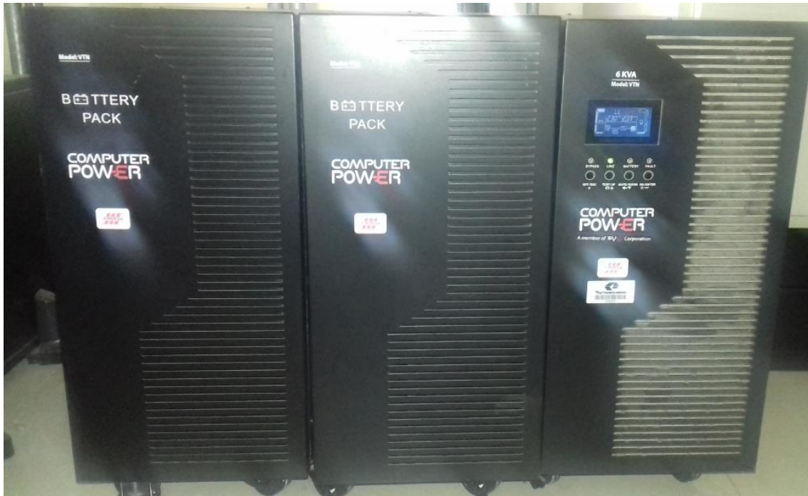
Figura 2.30. Sistema de respaldo de energía UPS.
