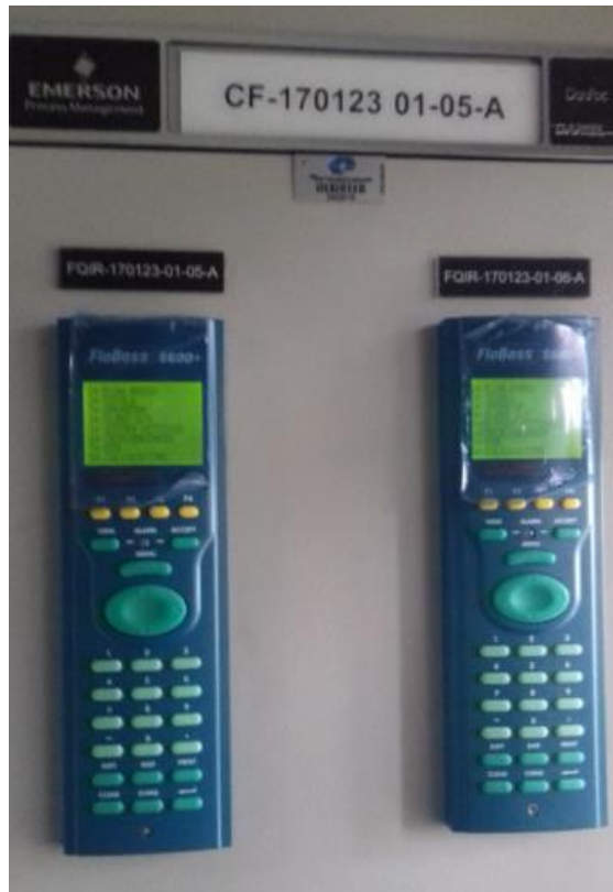
Figura 3.8. Computadores de flujo instalados.
