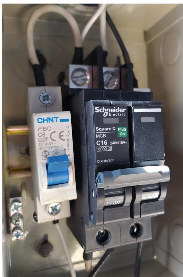
Figura 3.1 Interruptor termomagnéticos para circuito de control y potencia.
