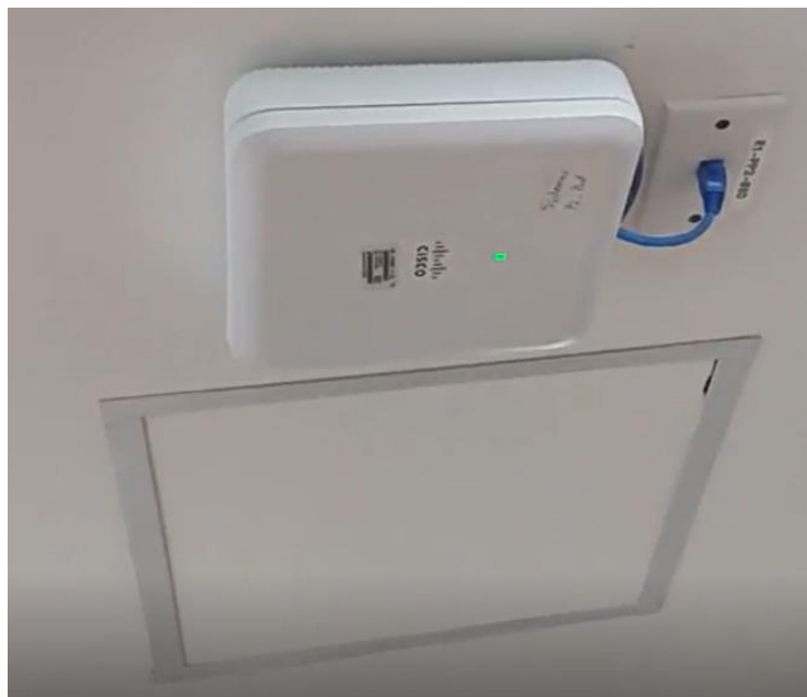
Figura 31 - Ubicación de Access Point en la parte superior Fuente: FIS
