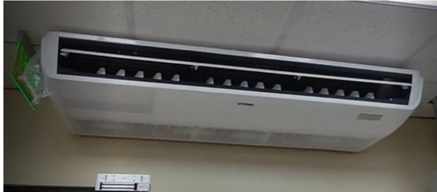
Figura 29 - Sistema de enfriamiento continuo Fuente: FIS
