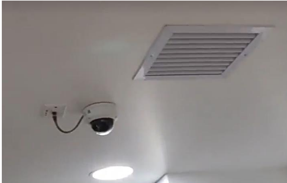
Figura 24 - Cámara de seguridad implementada en la FIS Fuente: FIS
