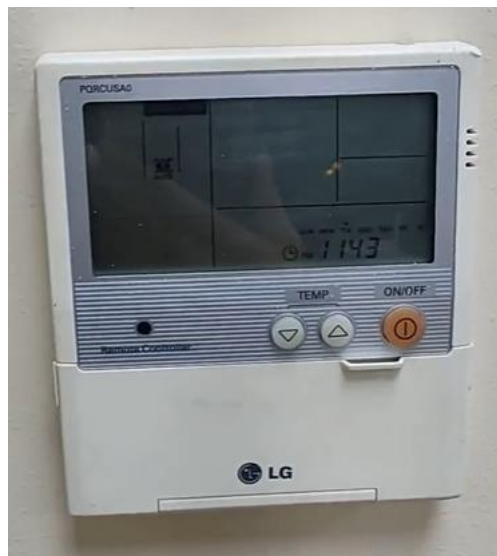
Figura 30 - Controlador del sistema de enfriamiento Fuente: FIS
