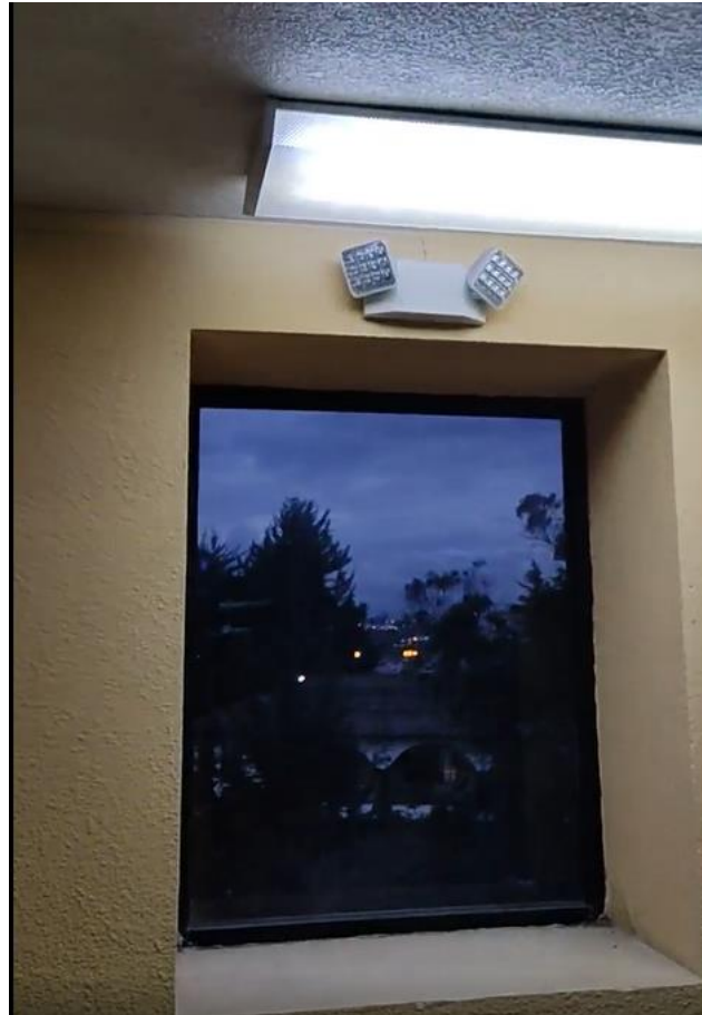
Figura 28 - Alarmas de emergencia Fuente: FIS
