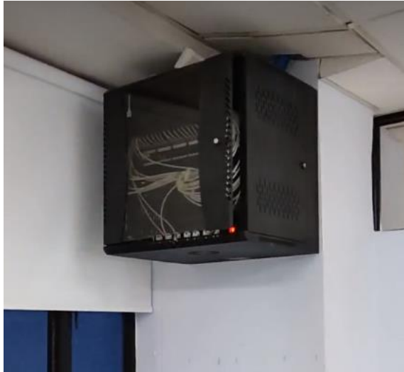
Figura 33 - Protección de switches Fuente: FIS
