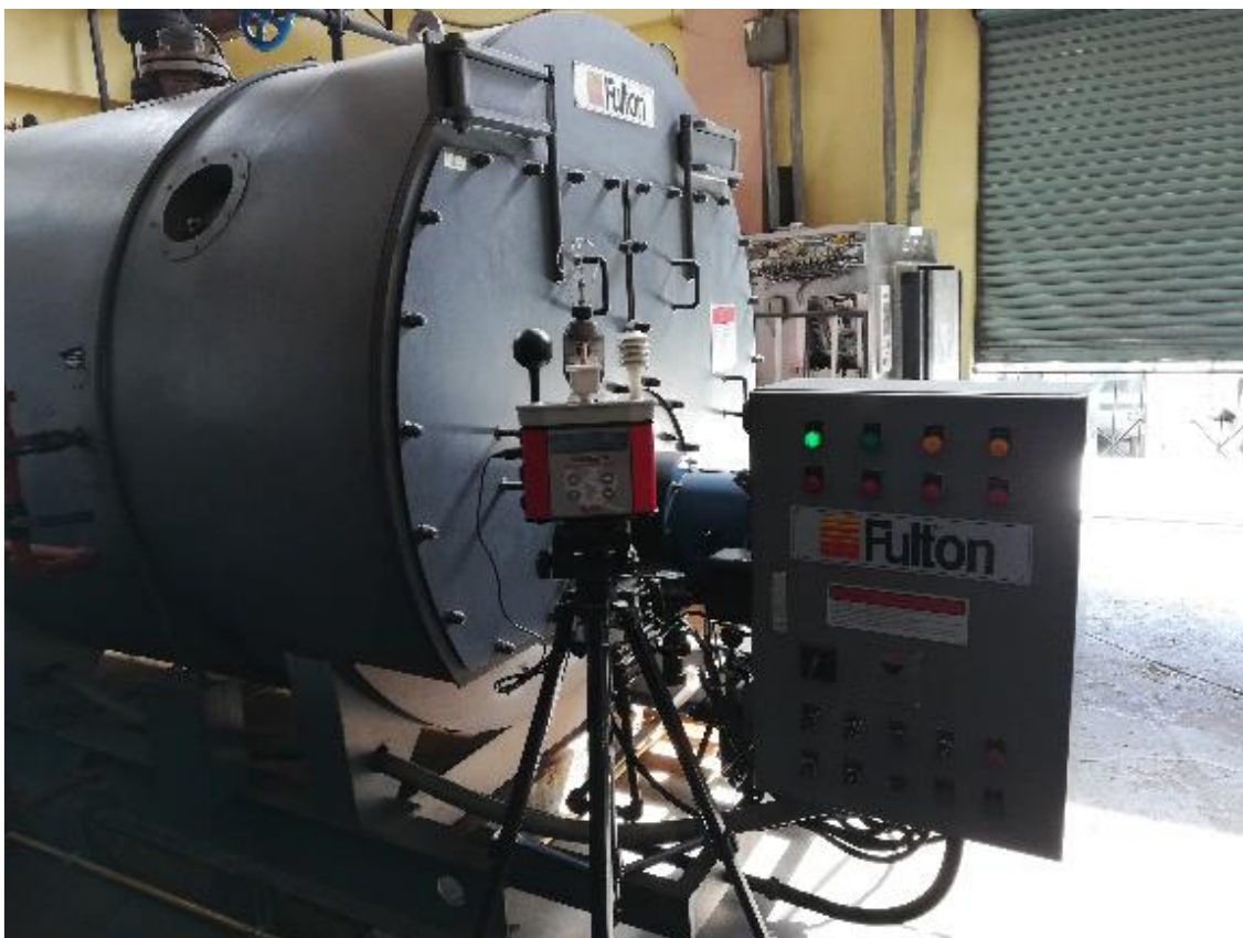
Figura 3.8. Equipo usado durante la medición de estrés térmico en la sala de calderos
