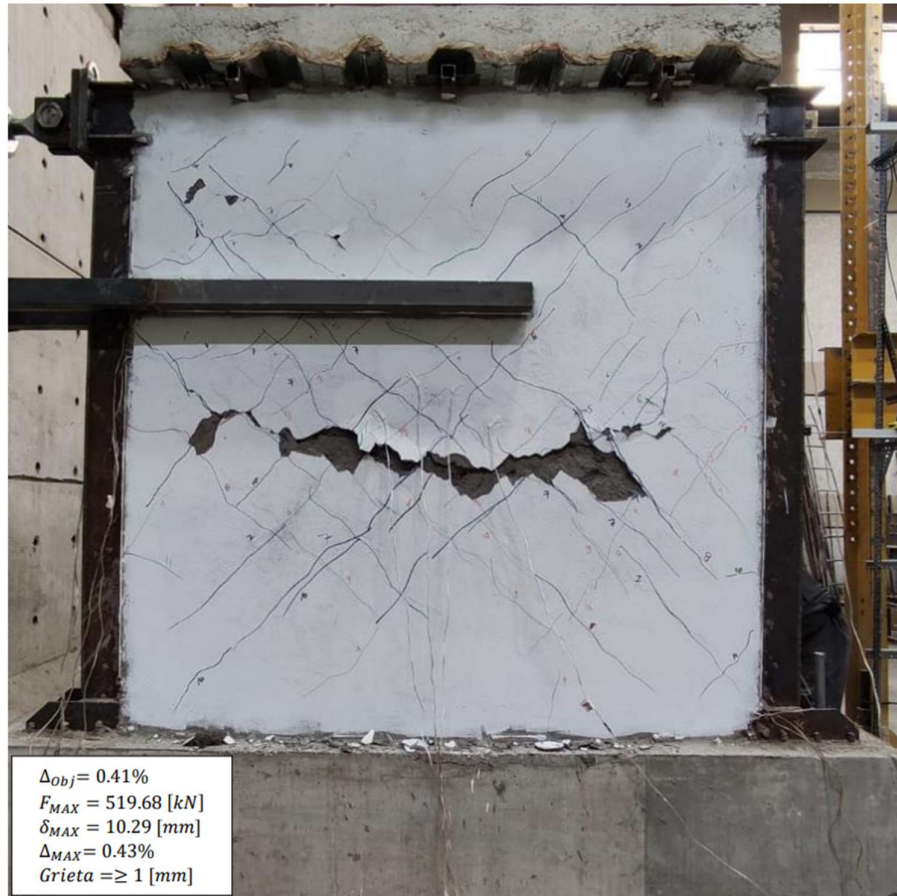
Figura 3.8. Prototipo I con daño previo, reforzado mediante enchape, ensayado a carga lateral en etapa “Daño extenso”. [22]
