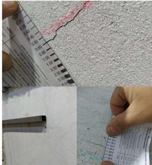
Figura 3.13. Prototipo II con daño previo, reforzado mediante enchape, ensayado a carga lateral en etapa “Daño leve”. [21]
