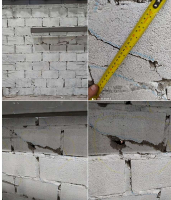
Figura 3.12. Prototipo II ensayado a carga lateral en etapa “Daño moderado”. [21]
