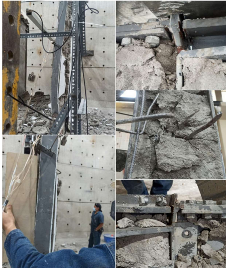
Figura 3.16. Prototipo II con daño previo, reforzado mediante enchape, ensayado a carga lateral en etapa “Estado de colapso”. [21]
