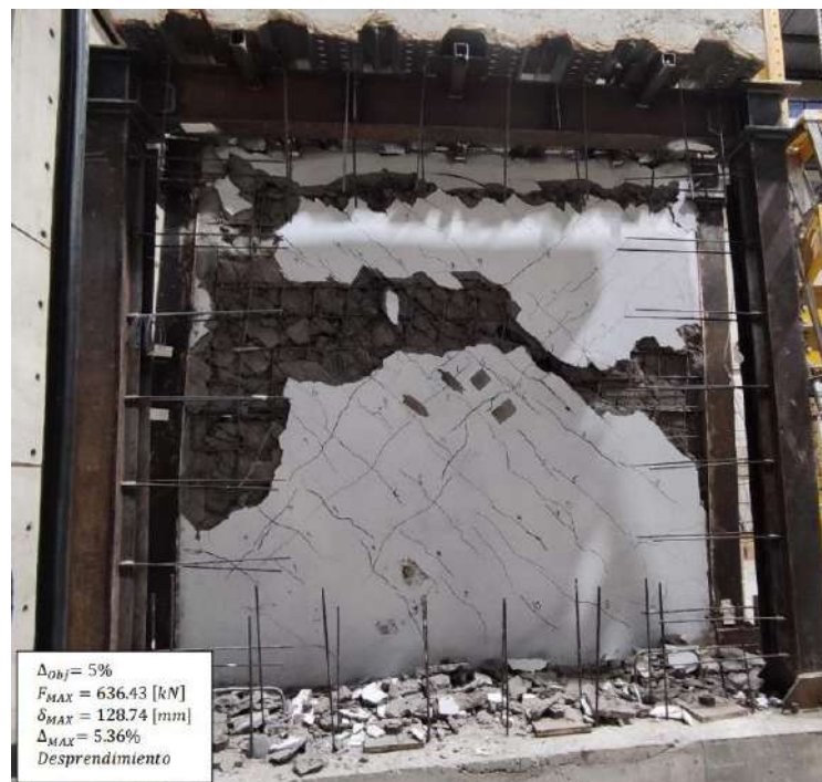
Figura 3.15. Daño Completo Final de Pórtico Enchapado sin Daño en la Mampostería del Prototipo de Ensayo 1 [34].
