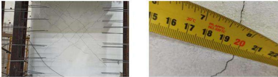
Figura 3.10. Daño Leve de Pórtico Enchapado sin Daño en la Mampostería del Prototipo de Ensayo 2 [31].
