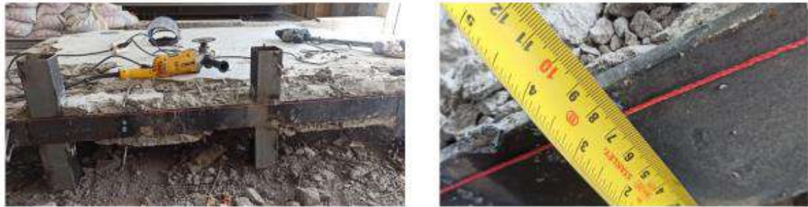
Figura 3.16. Pandeo de Viga de Pórtico Enchapado sin Daño en la Mampostería del Prototipo de Ensayo 2 [31].
