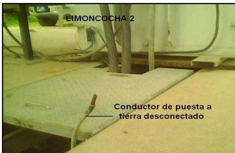
Figura 6.2 Limoncocha 2, conductor de puesta a tierra desconectado
