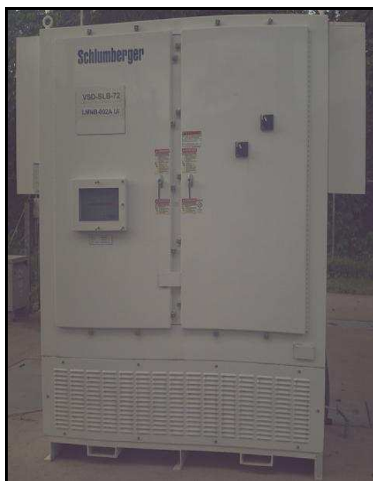
Figura 4.8 VSD de 12 pulsos de 910 kVA (Cortesía de Schlumberger).
