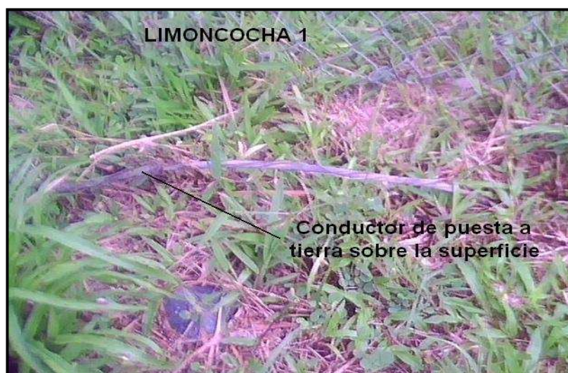
Figura 6.3 Limoncocha 1, conductor de puesta a tierra no enterrado.
