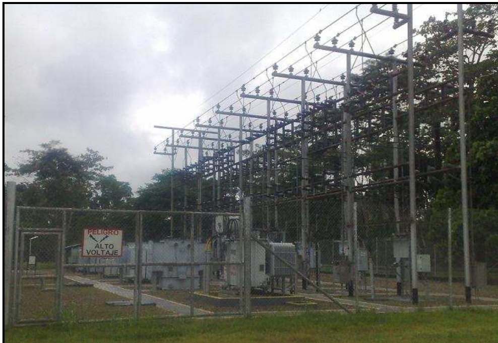
Figura 2.13 Subestación Limoncocha (cortesía Petroamazonas)
