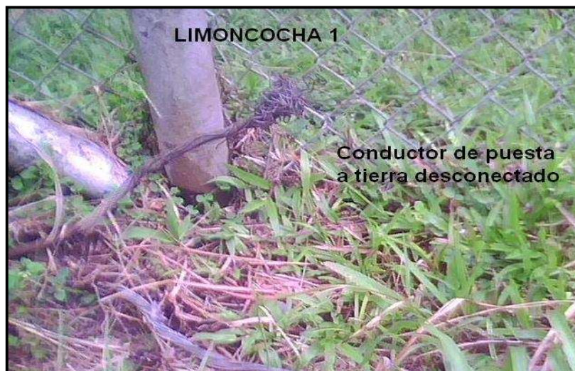
Figura 6.1 Limoncocha 1, conductor de puesta a tierra no conectado.
