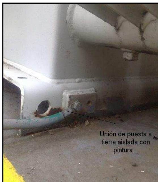
Figura 6.7 Estación Limoncocha XFML 05, conexión de puesta a tierra aislado con pintura.
