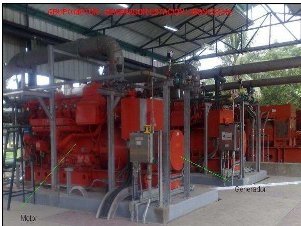
Figura 2.12 Grupo motor – generador marca Waukesha, 4160 V. (Cortesía Petroamazonas)
