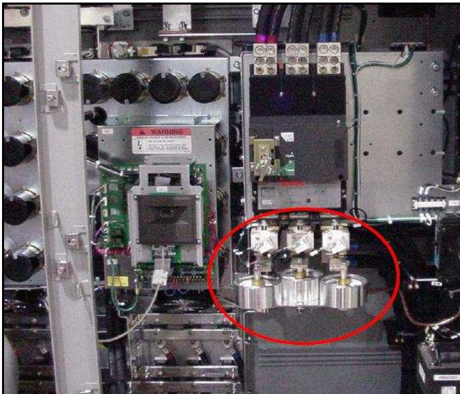
Figura 4.90 TVSS conectado a un VSD de 815 kVA (Cortesía de Schlumberger).
