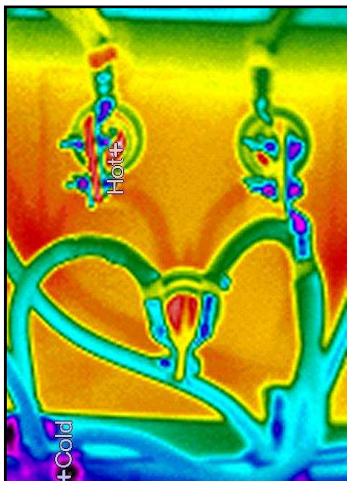
Figura 2.2 Terminales del transformador XFM 01 a 4160 V de la locación Limoncocha 10
