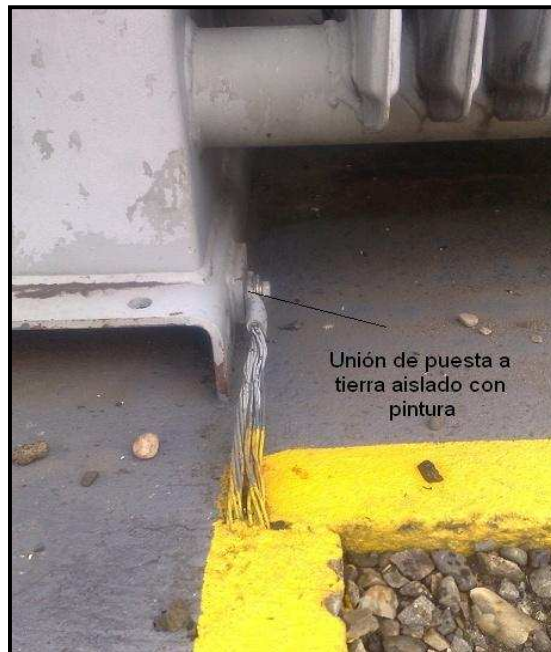
Figura 6.6 Estación Limoncocha XFML 02, conexión de puesta a tierra aislado con pintura.
