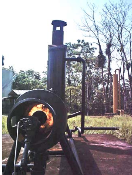
Figura N° 1.11. Fotografía del calentador de Lago Norte.
