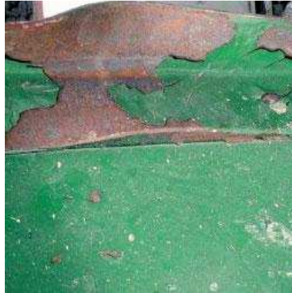
Figura 1.13. Fallo por delaminación (Sherwin-Williams Company, 2005)
