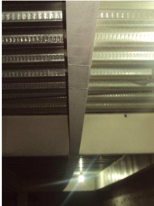
Figura 4.5. Pandeo en vigas.
