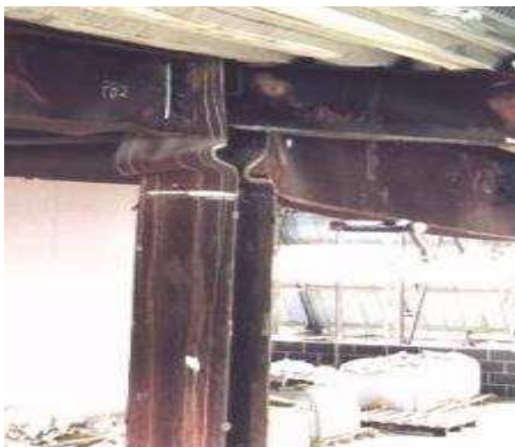
Figura 2.17 Excesiva deformación plástica de una columna. 36
