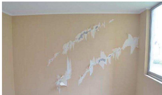
Figura 2.6. Falla de muro de concreto por corte.
