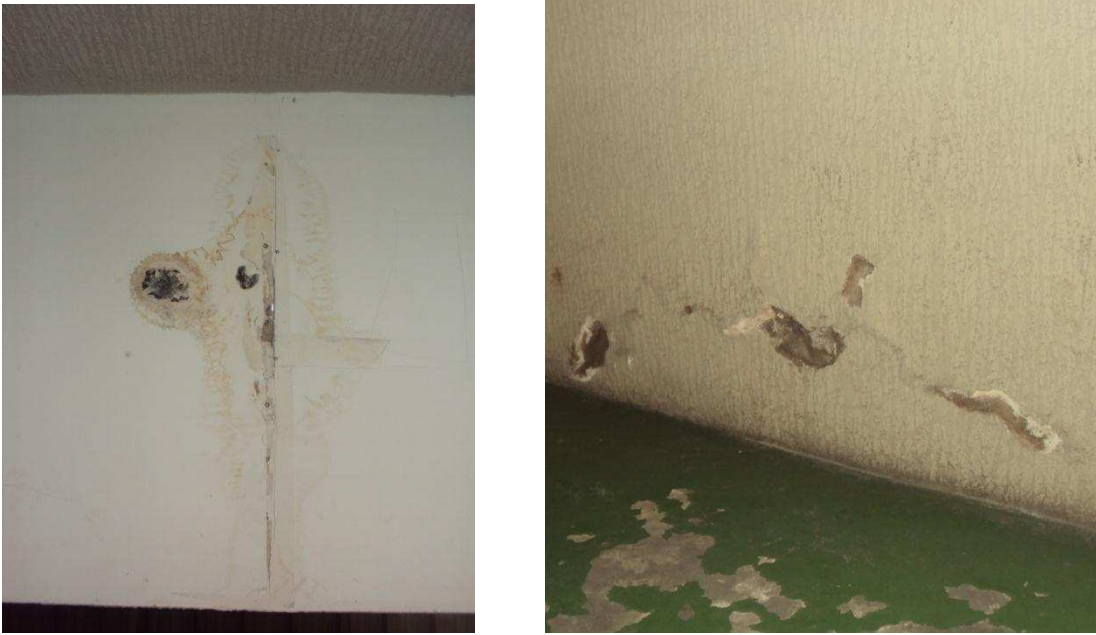
Figura 4.11. Presencia de humedad en muros de escaleras.
