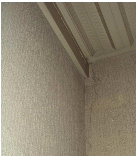
Figura 4.10. Fisuras en muros de escaleras.
