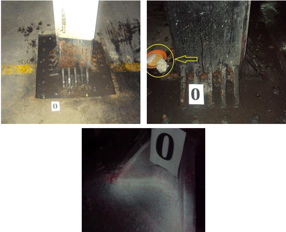
Figura 4.61. Corrosión agresiva en placa base “O” agravada por la existencia de una toma de agua en su columna.
