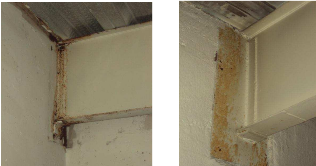
Figura 4.7. Corrosión galvánica unión viga-muro de contención.
