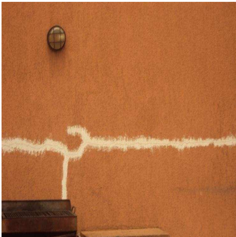
Figura 4.15. Fisuras en muros de la terraza.
