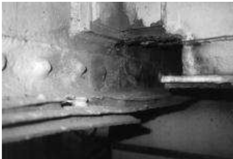
Figura 2.19. Perdida de sección por oxidación. 38
