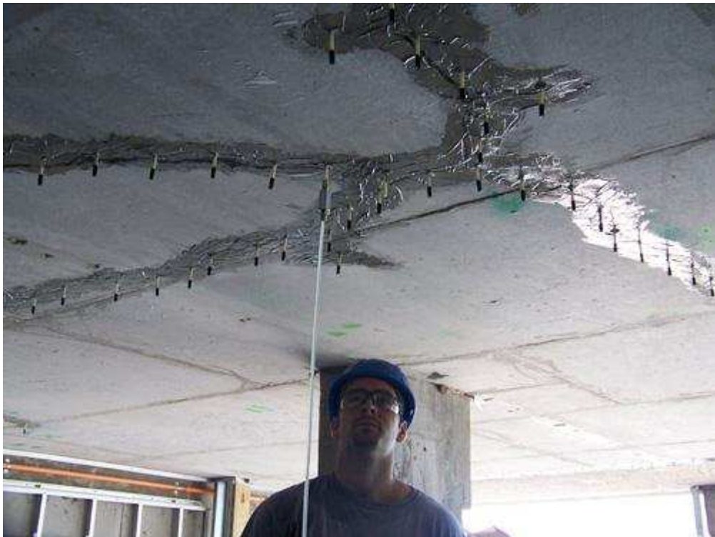
Figura 2.11. Reparación de fisuras en una losa mediante la inyección de resina epoxi. 32
