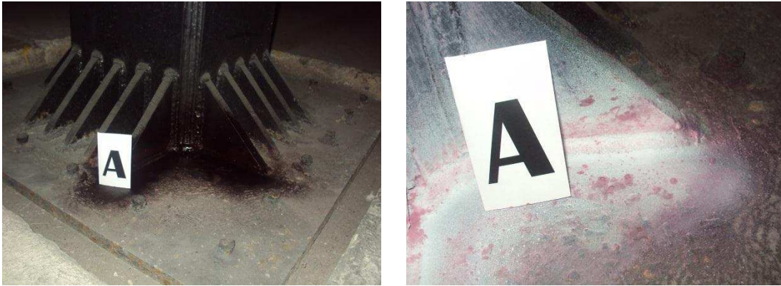
Figura 4.59. Presencia de corrosión bajo la protección anticorrosiva de la placa base "A".
