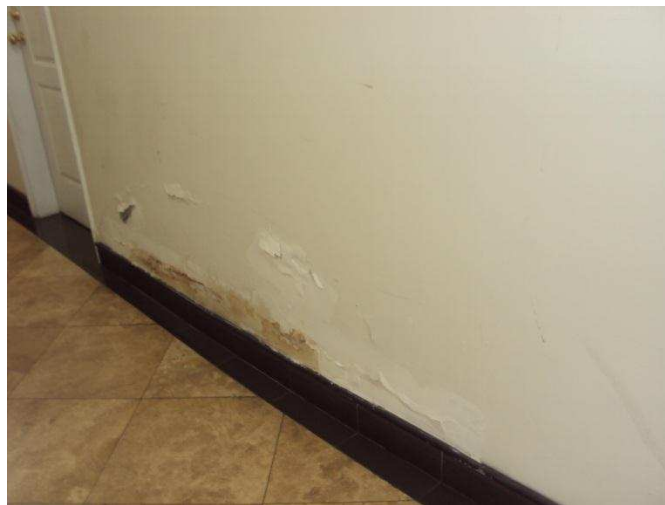
Figura 4.12. Presencia de humedad en muros de pasillos.
