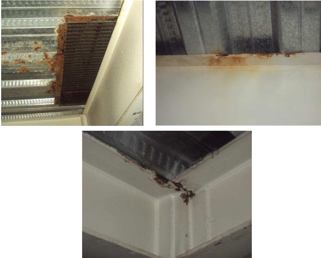
Figura 4.8. Corrosión galvánica-subsuelos Ardres Plaza.
