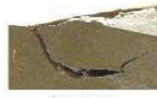
Figura 2.35. Desgarre laminar en soldadura.
