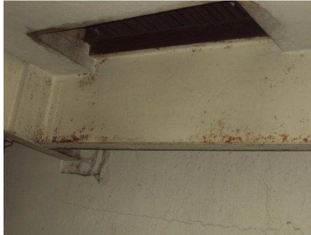
Figura 4.6. Corrosión generalizada en vigas y conexiones.
