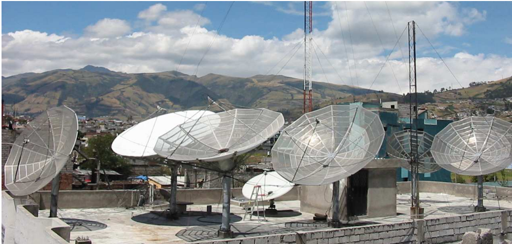
Figura 1.4: Fotografía de las antenas de recepción satelital
