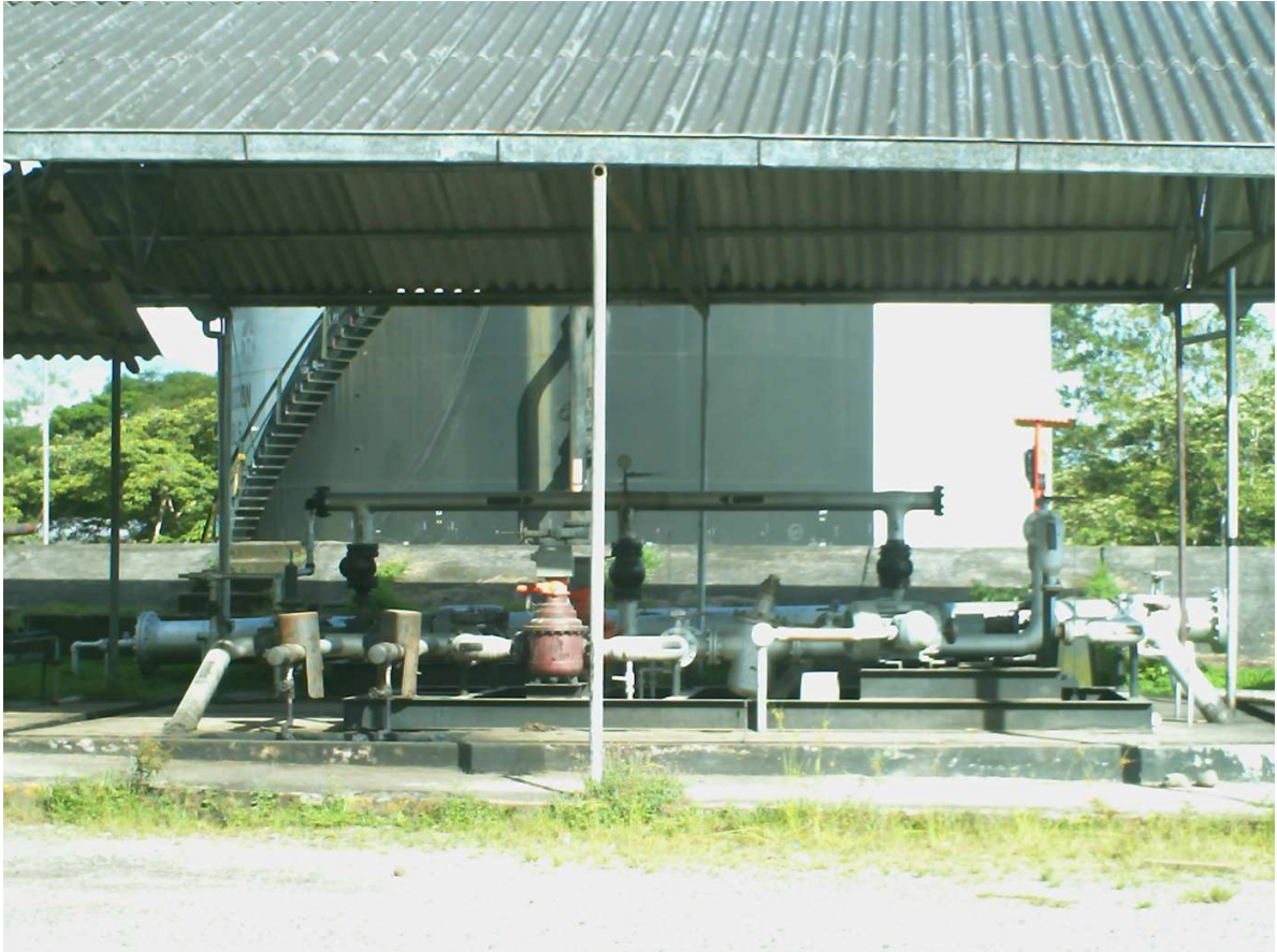
FOTO A 3.2.5 BOMBAS BOOSTER ESTACION LAGO CENTRAL
