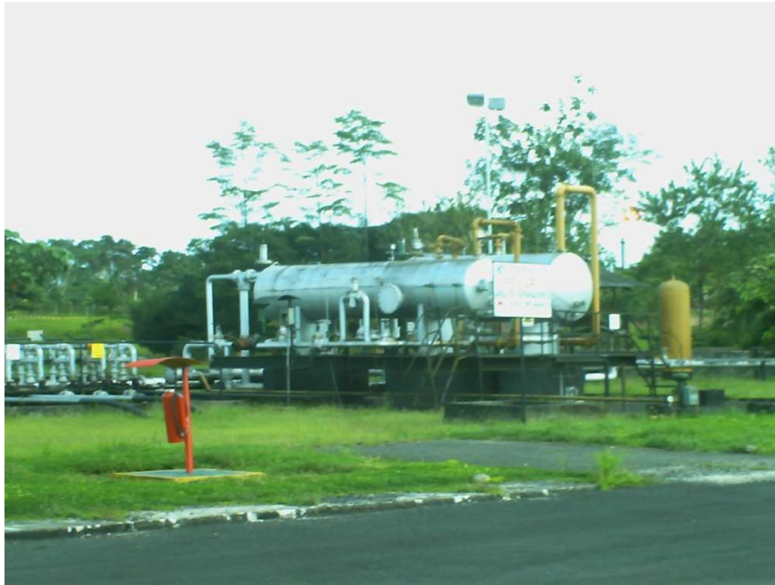
FOTO A 3.2.3 SEPARADORES ESTACION CENTRAL
