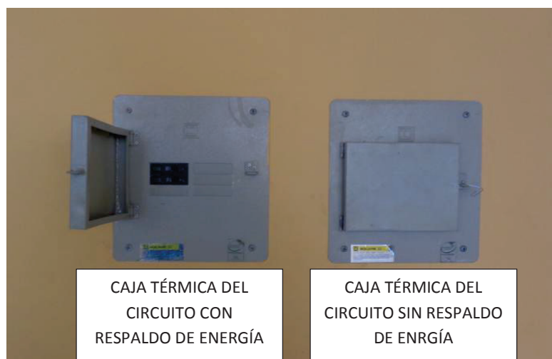
Figura 2.28. Cajas térmicas de la red eléctrica de la UESDS
