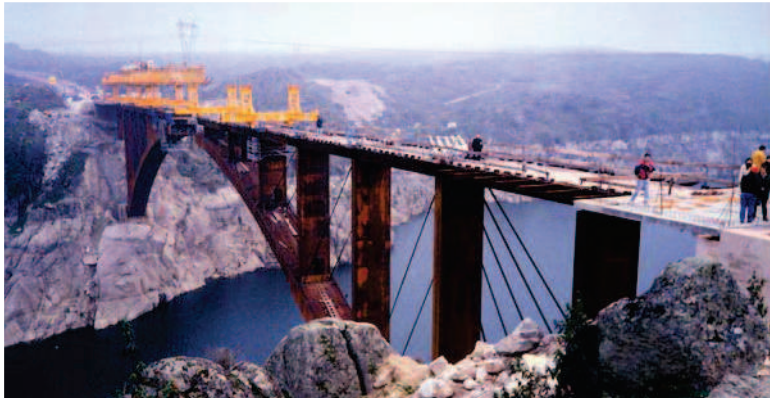
Figura 3.26 Imagen de los dos voladizos. Obsérvese la ausencia de la losa superior del tablero, sustituido temporalmente por tabloncillos de madera.
