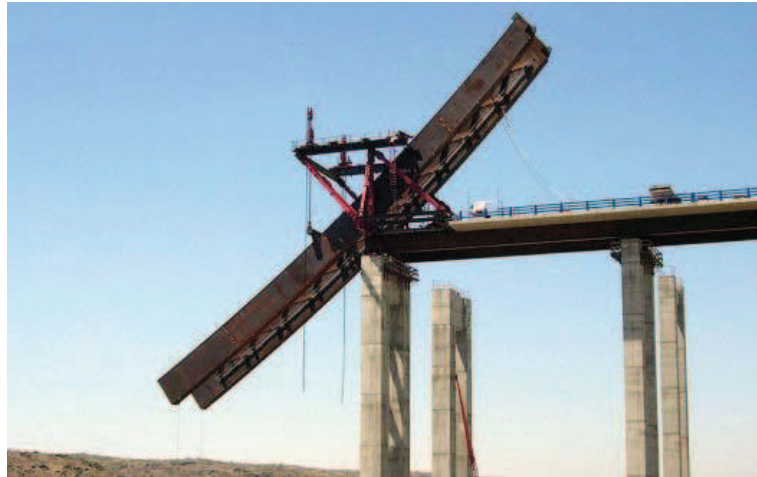
Figura 3.12 Basculamiento del \frac{1}{4} del arco.
