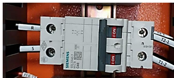
Figura 6. – Protección termomagnética bipolar de 40 [A].
