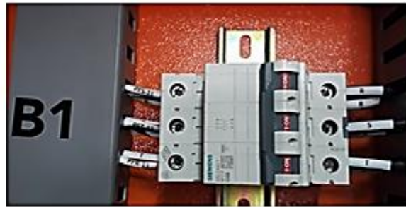
Breaker principal de alimentación del tablero
