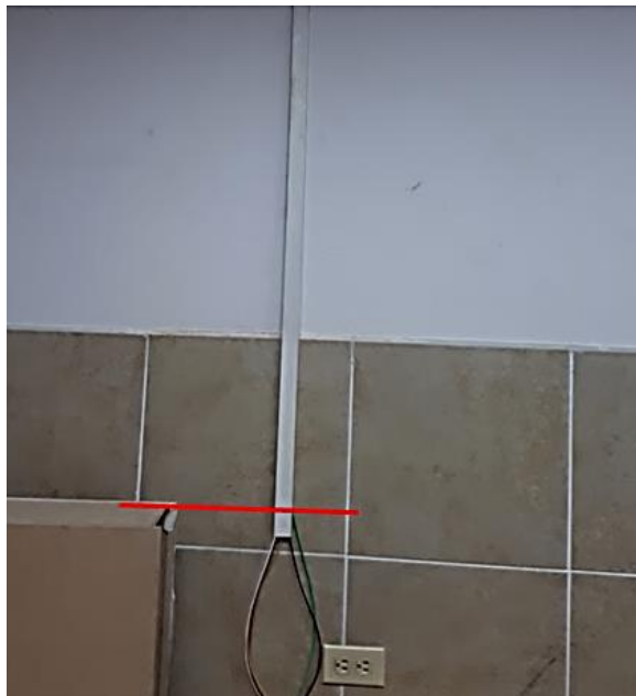
Figura 34. – Canaletización de distribución a cada mesa de trabajo.
