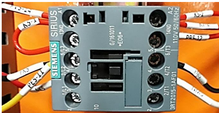
Figura 4. – Contactores de 7 [A] para energización de módulos.
