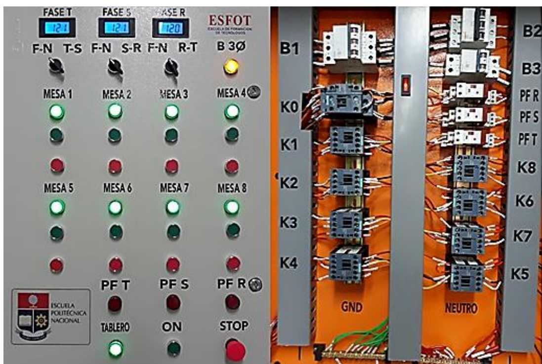
Figura 1. – Tablero de control.
