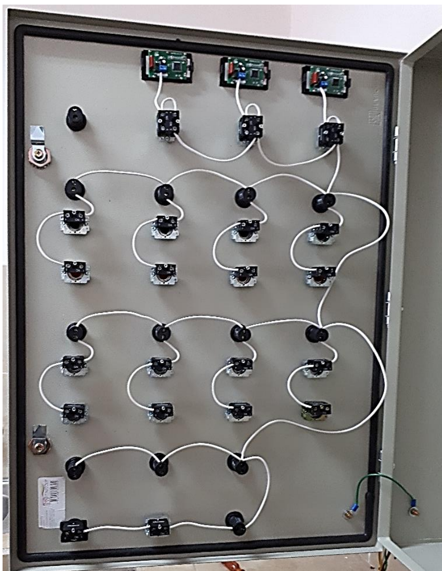
Figura 18. – Cableado de los puntos neutros de los elementos.
