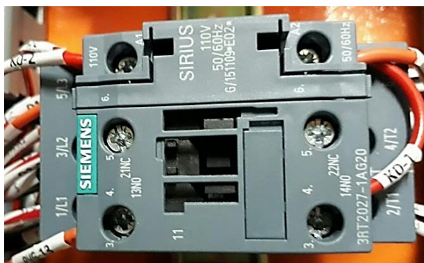
Figura 5. – Contactor de 32 [A] para energización del tablero.
