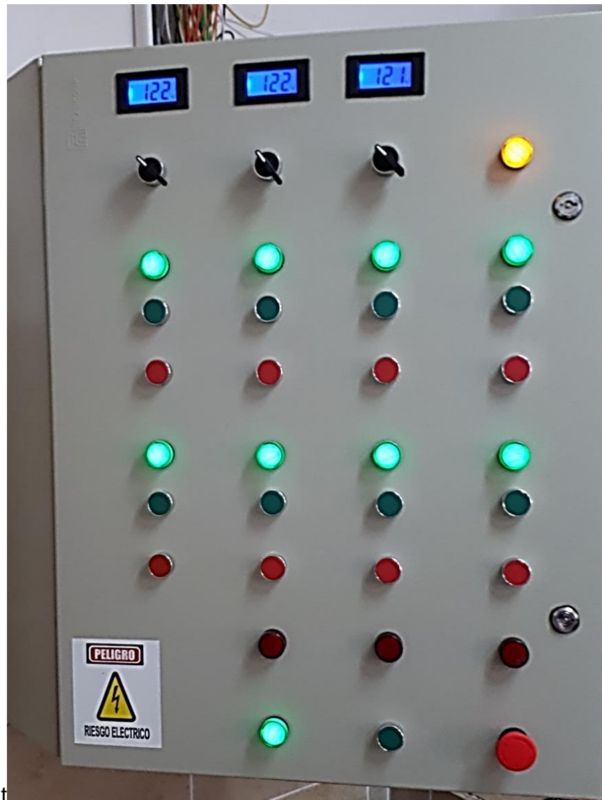
Figura 26. – Tapa vista frontal sin señalización.
