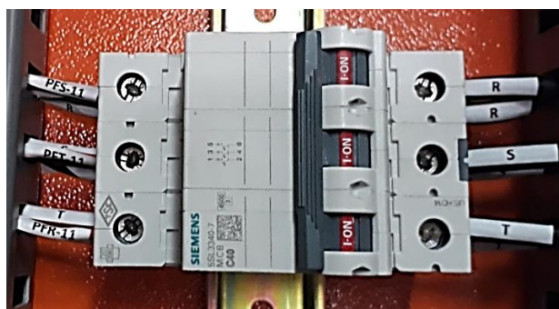
Figura 7. – Protección termomagnética tripolar de 40 [A].
