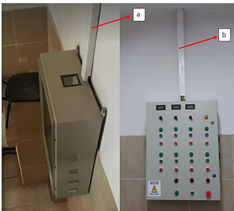
Figura 33. – Canaleta principal de acometida.
