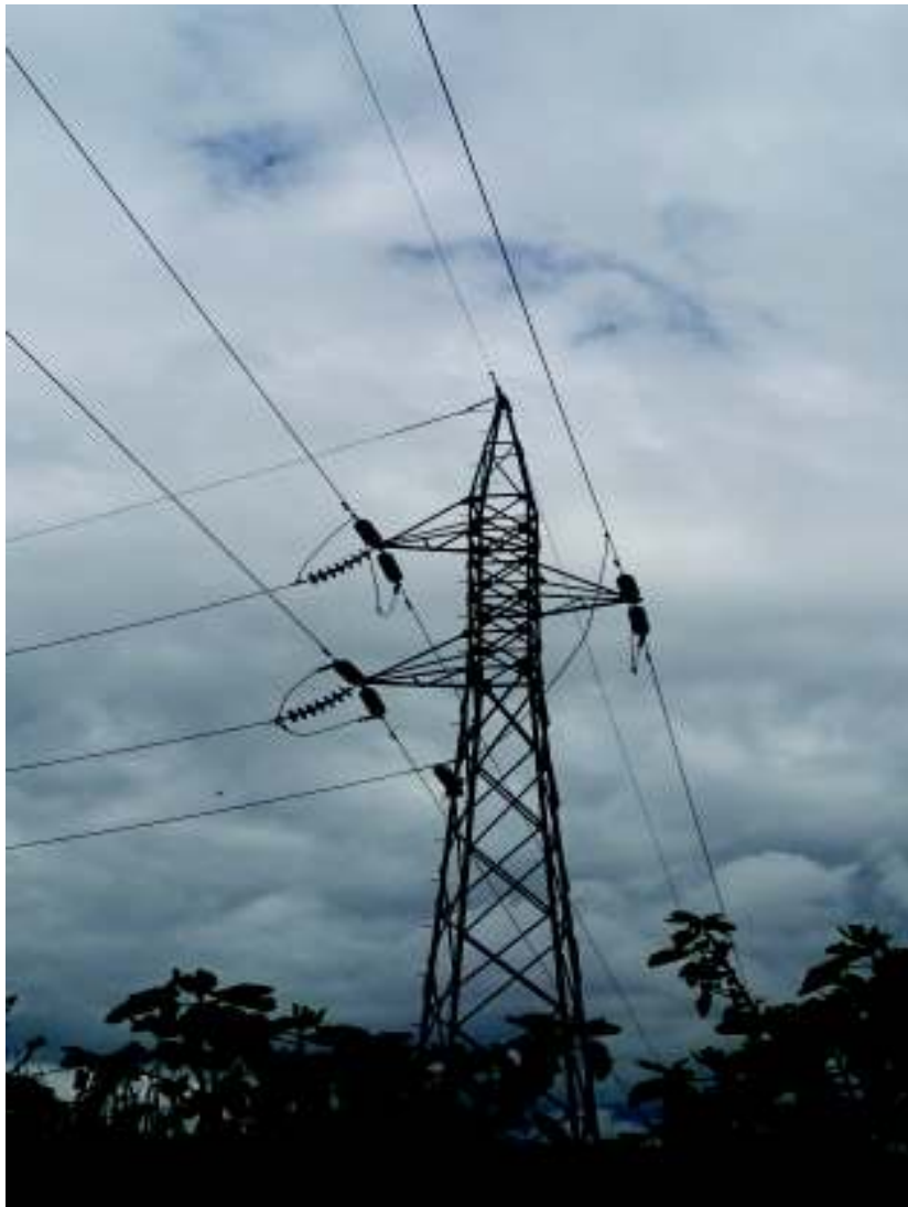
Figura 3.1. Torre #069 propiedad de la EEASA con derivación directa tipo “T” de la línea de S/T, Ambato – Loreto – Oriente (sin equipos de corte y seccionamiento)
