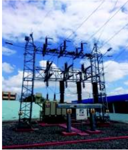
Figura 3.26. Pórtico eléctrico para el transformador 1 de la S/E Loreto.
