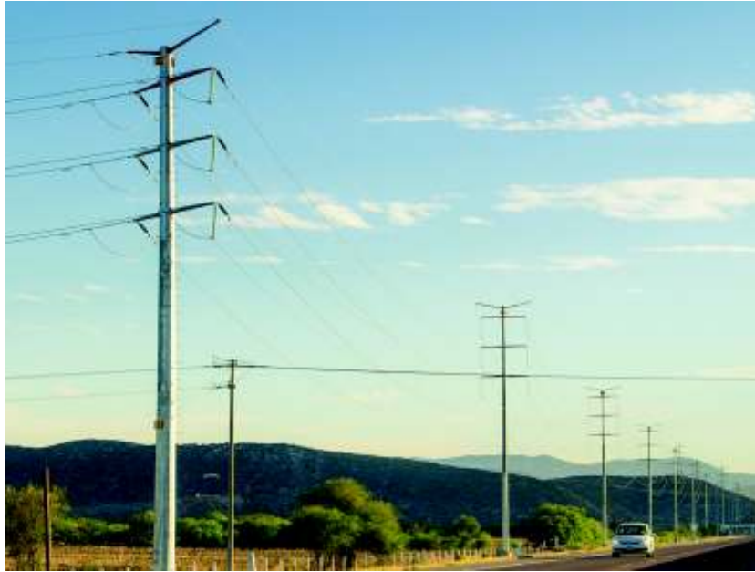
Figura 3.35. Poste metálico de 69 kV tipo troncocónico [34].
