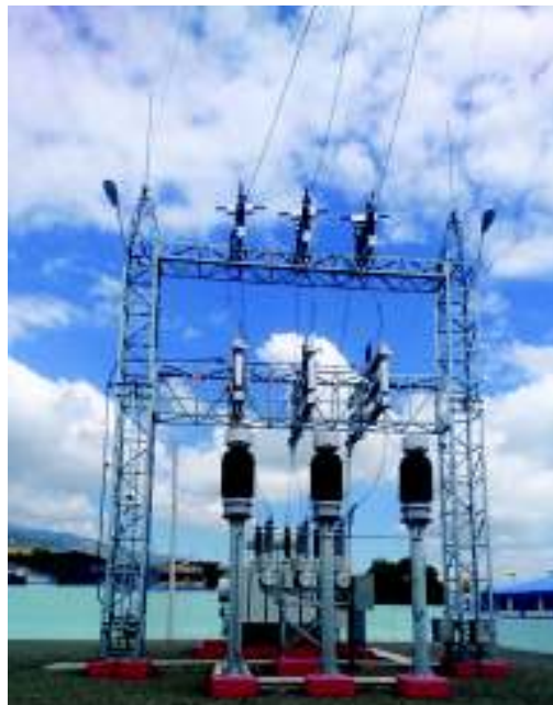
Figura 3.27. Pórtico eléctrico para el transformador 2 de la S/E Loreto.
