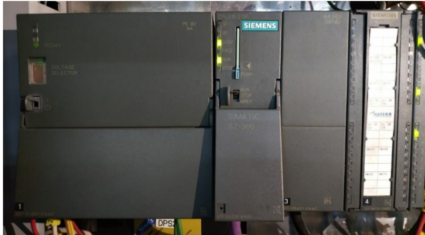
Figura 2.2 PLC Siemens S7 300 Utilizado en la Máquina.
