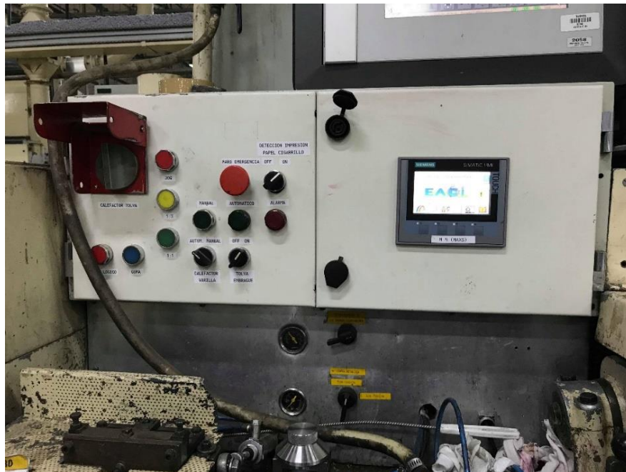
Figura 3.1 Panel Táctil Instalado y en Funcionamiento.
