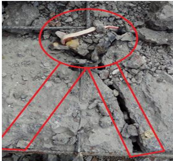
FIGURA 5.34 Falla hormigón probeta M4-280-45-1.
