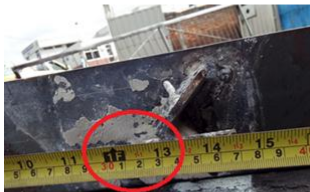
FIGURA 5.36 Medida separación losa izquierda.
