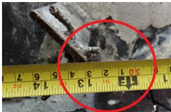
FIGURA 5.35 Medida separación losa izquierda.
