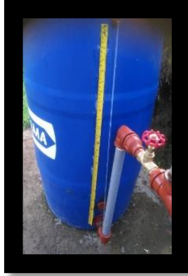
FIGURA 15 NIVEL DE AGUA Y CLORADOR POR CONTACTO
