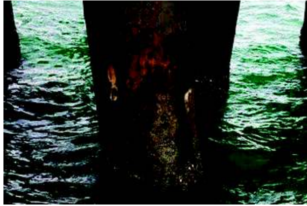
Figura 1.10. Corrosión marina en aceros Dúplex.
