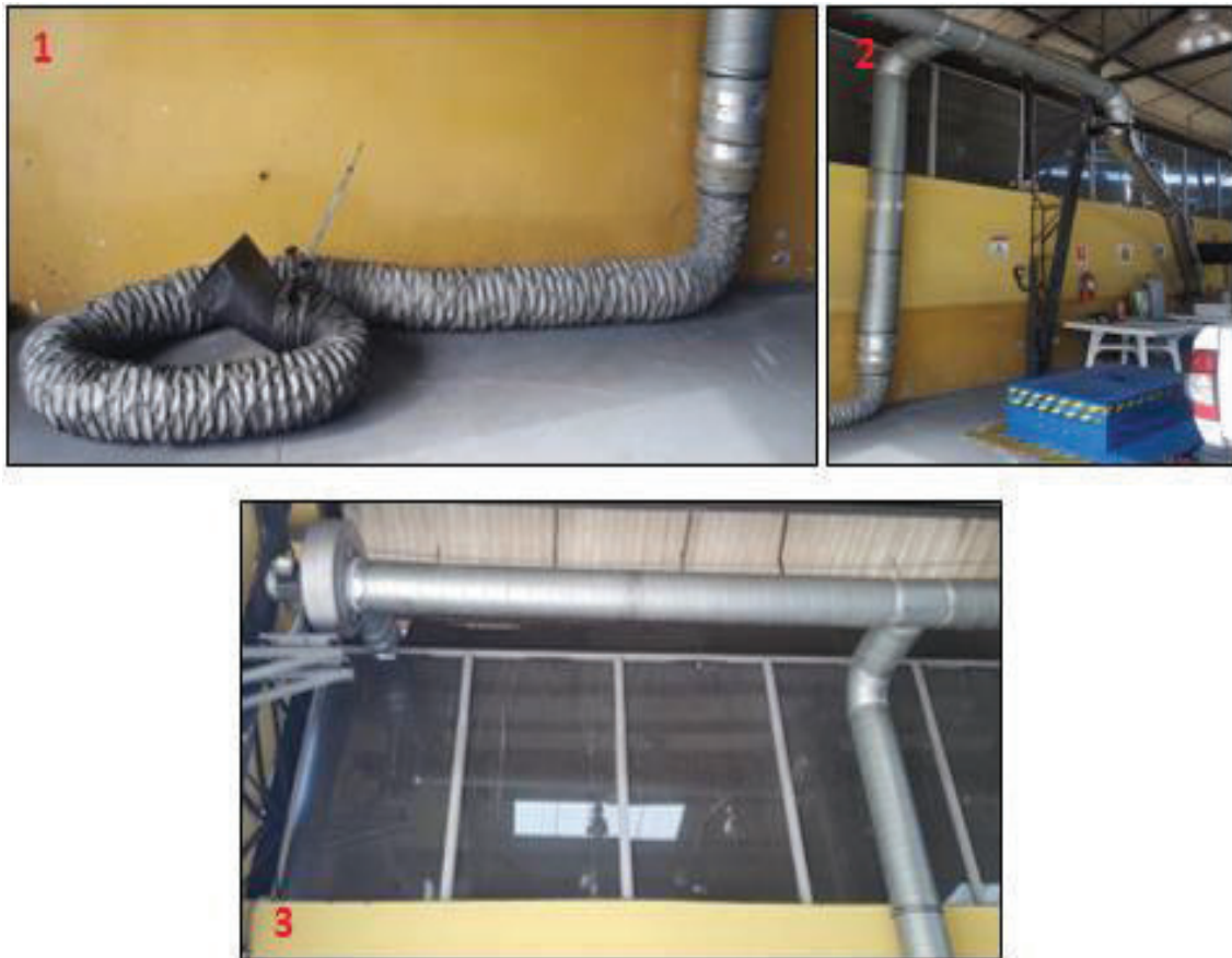
Figura 2. 6. Sistema de extracción de gases.
