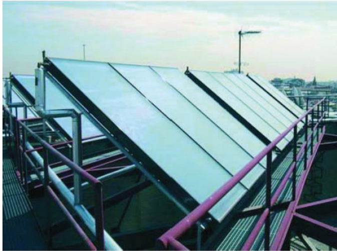
Figura 2.6 Solar térmica en un hotel de Madrid.
