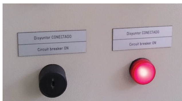
Figura 5.2 Estado de disyuntor de la central
