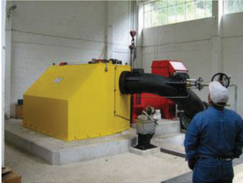
Figura 2.4 Mini central hidroeléctrica Perlabí
