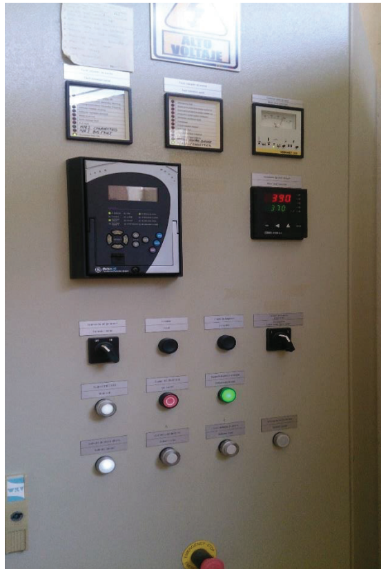
Figura 5.1 Panel de control y protección de la Central Perlabí
