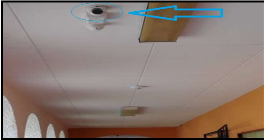
FIGURA 3.22 Cámara instalada 3, entrada la oficina ET-OF23
