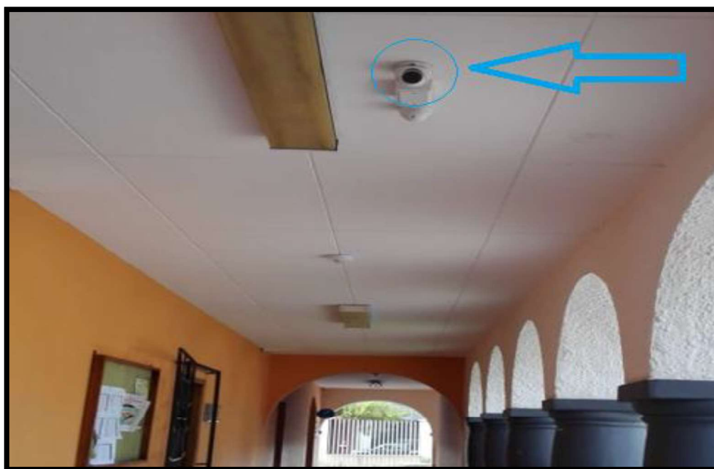
FIGURA 3.21 Cámara instalada 2, entrada a la oficina ET-OF14
