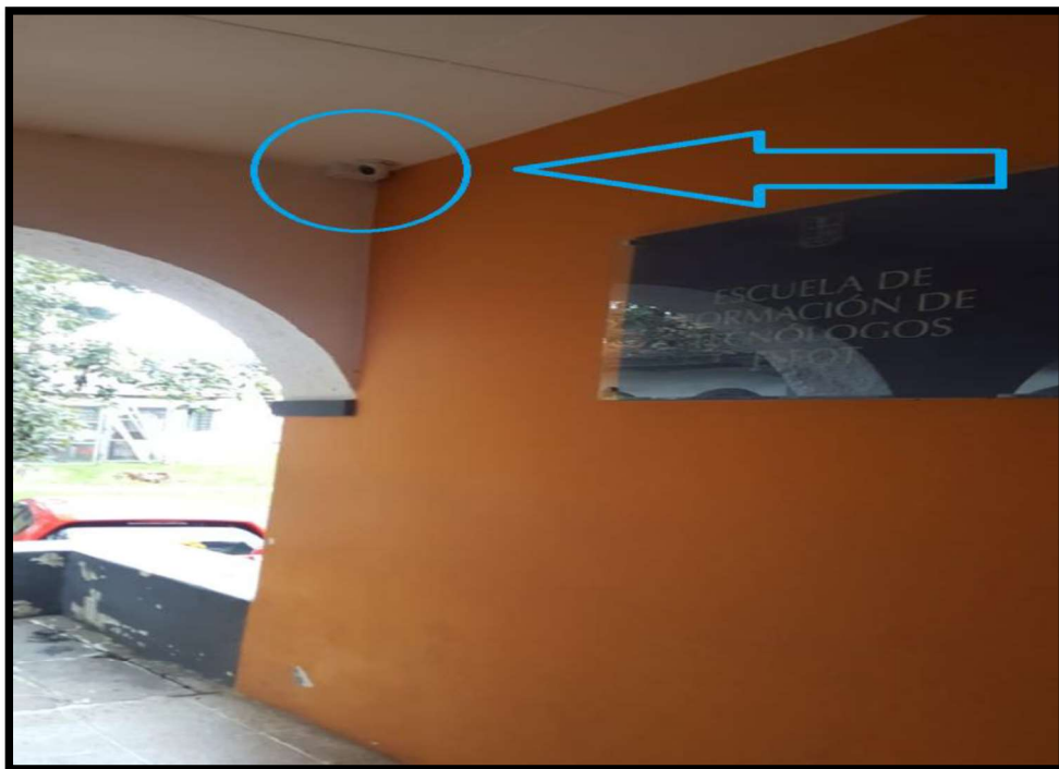
FIGURA 3.20 Cámara instalada 1, entrada a oficina ET-OF02
