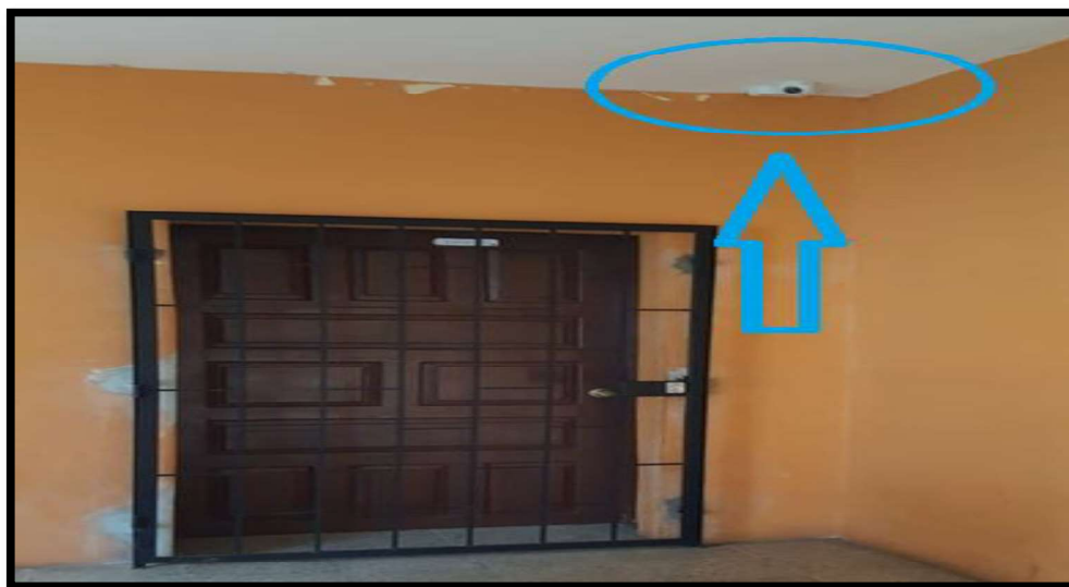
FIGURA 3.23 Cámara instalada 4, entrada al aula ET-016
