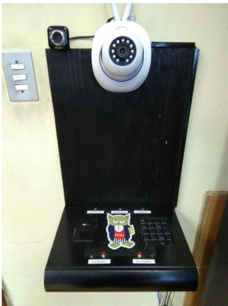
Figura 2.55. Ubicación física de los terminales de acceso en la pared.
