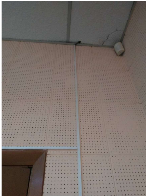
Figura 2.60. Cableado hacia el techo raso.
