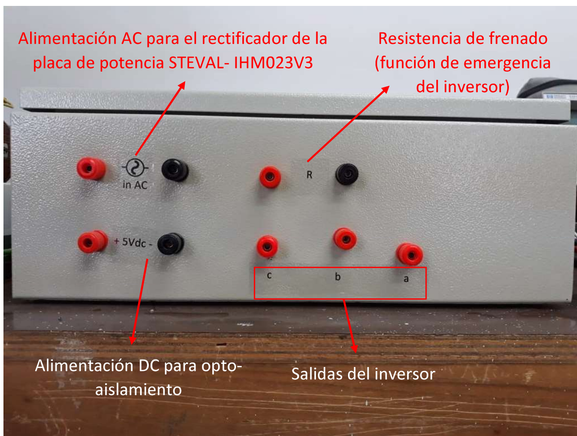
Figura 3.23. Borneras de conexiones periféricas de la estructura metálica
