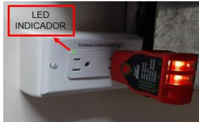
Figura E2: Led indicador para el tomacorriente con DPS tipo 3 Fuente: Propia
