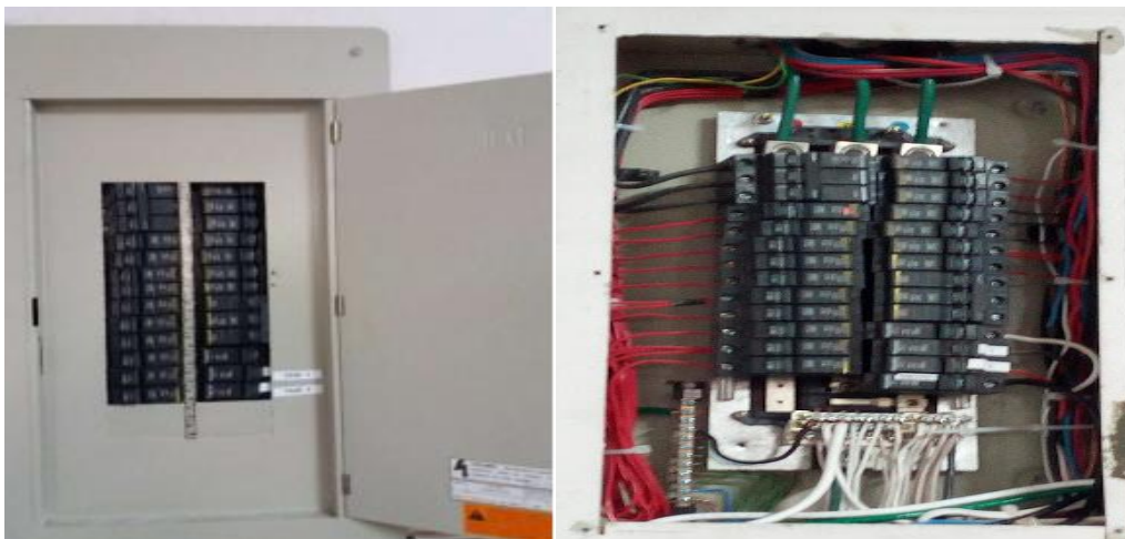
Figura 3.3: Tablero de distribución principal. Fuente: (Propia)
