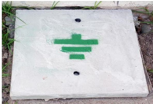
Figura 3.28: Cajas de inspección de puesta a tierra. Fuente: (Propia)
