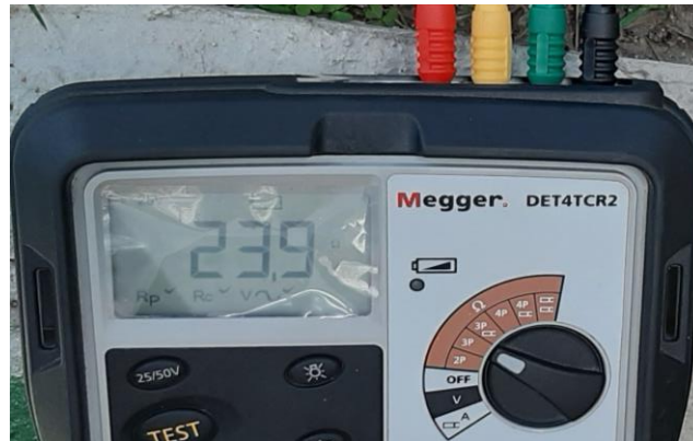
Figura 3.29: Valor de puesta a tierra antigua en el edificio de la Dirección ESFOT Fuente: (Propia)
