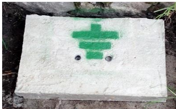
Figura 3.35: Cajas de inspección de puesta a tierra. Fuente: (Propia)
