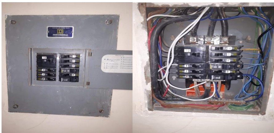
Figura 3.4: Tablero de distribución secundario Fuente: (Propia)
