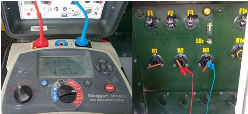
Figura 3.3. Medición de la resistencia de aislamiento entre las fases H2 y H3 de la entrada de una caja de maniobras trifásica [Elaboración Propia].
