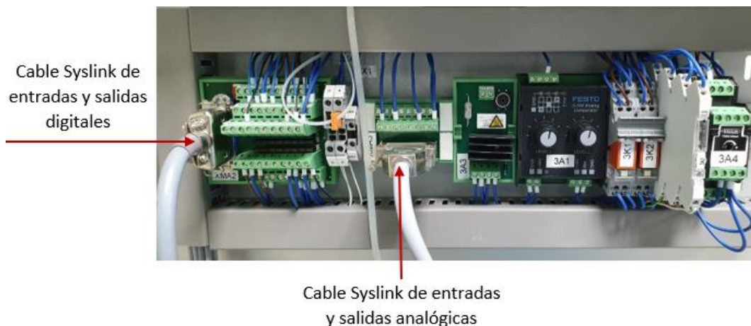
Figura 12. Conexiones de los cables de datos del sistema reactor Festo.
