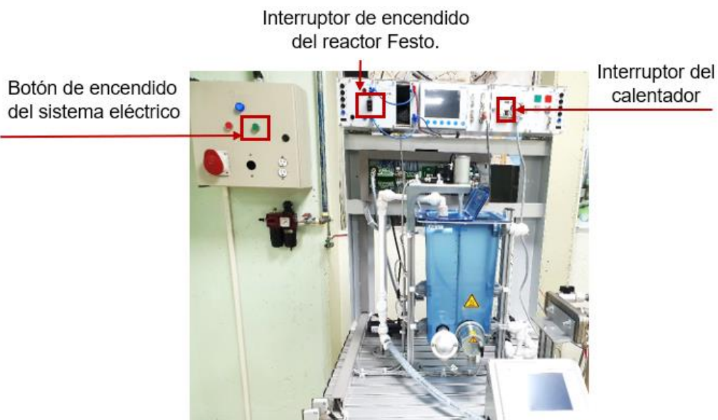
Figura 11. Conexiones eléctricas del sistema reactor Festo.
