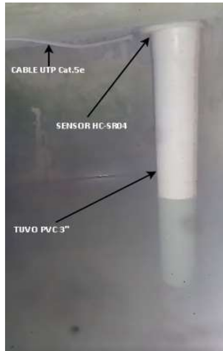
Figura 2.44 Instalación de sensores HC-SR04
