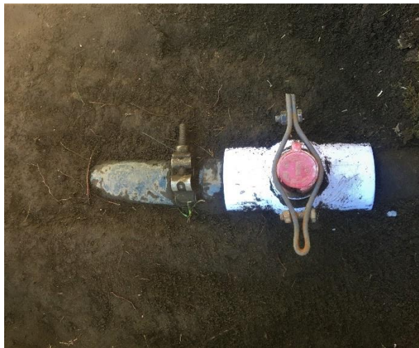
Figura 3.16 Válvula de bola de 2 (pulg) a la salida del tanque reservorio (Fuente Propia)
