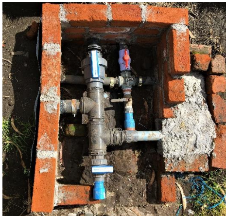
Figura 3.26 Toma de conexión 2 (TC2) (Fuente Propia)
