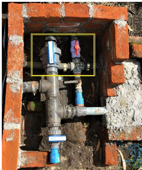
Figura 3.39 Apertura de las válvulas principales en la toma de conexión TC2 (Fuente Propia)
