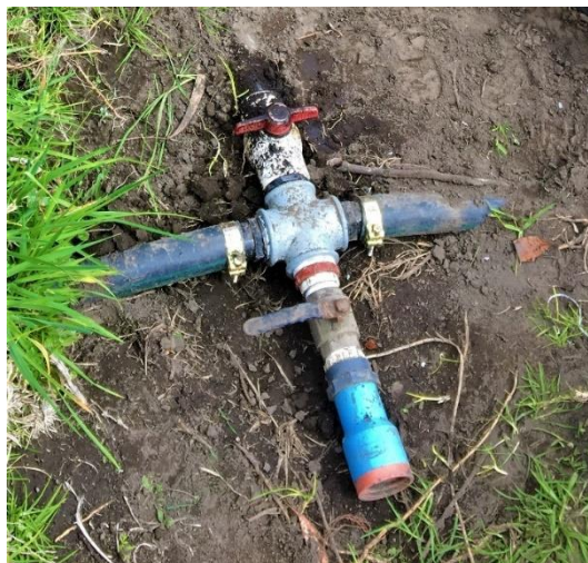
Figura 3.5 Estado de la toma de conexión fija del sistema antiguo (Fuente Propia)
