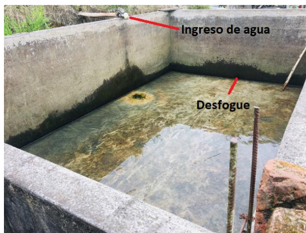
Figura 3.1 Tubería de suministro de agua del tanque reservorio y desfogue (Fuente Propia)
