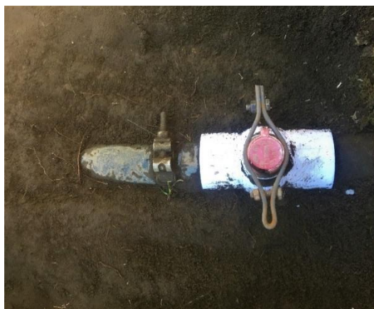
Figura 3.4 Válvula de control para sistema de riego antiguo (Fuente Propia)
