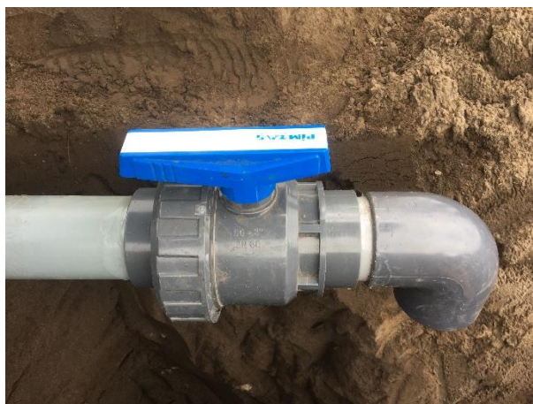
Figura 3.17 Válvula universal de 3 (pulg) a la salida del tanque reservorio (Fuente Propia)
