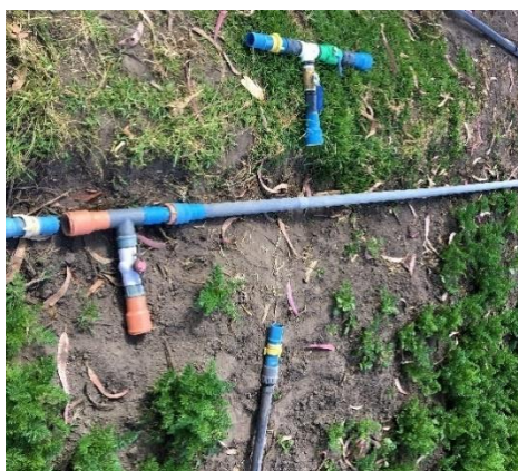
Figura 3.6 Estado del sistema de tuberías móviles (Fuente Propia)
