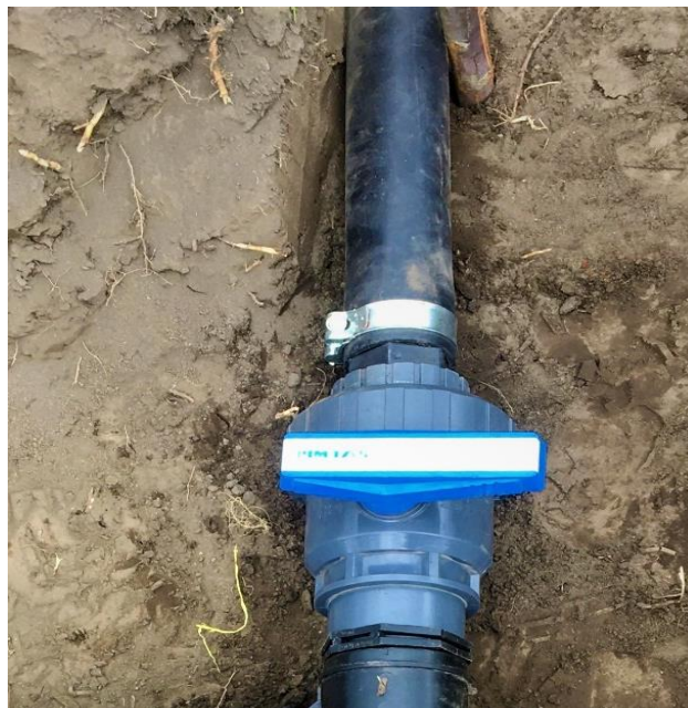
Figura 3.25 Conexión de manguera con válvula en toma de conexión (Fuente Propia)
