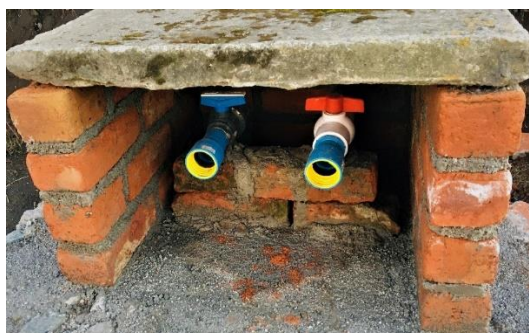
Figura 3.30 Toma de conexión fija 1 (TC1) (Fuente Propia)
