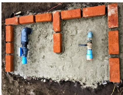
Figura 3.28 Toma de conexión 3 (TC3) (Fuente Propia)
