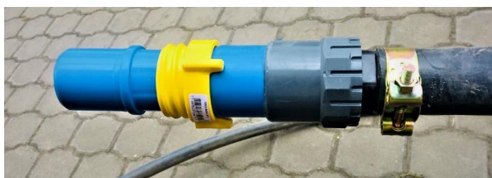
Figura 3.32 Conexión de punta macho en manguera (Fuente Propia)
