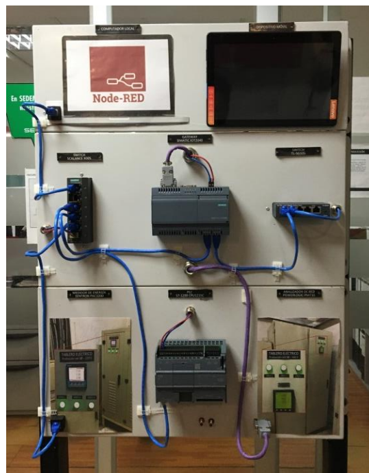
Figura 2.166. Cableado de red de comunicación
