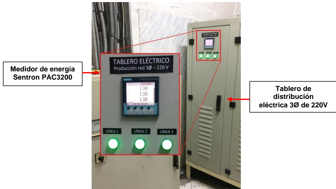
Figura 2.7. Tablero de distribución eléctrica de la red 3Ø de 220V del área de Producción
