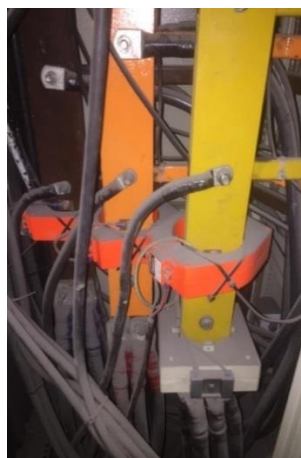
Figura 2.13. Transformadores de corriente CFS-103 Camsco instalados en las barras de la red eléctrica 3Ø de 440V del área de Producción
