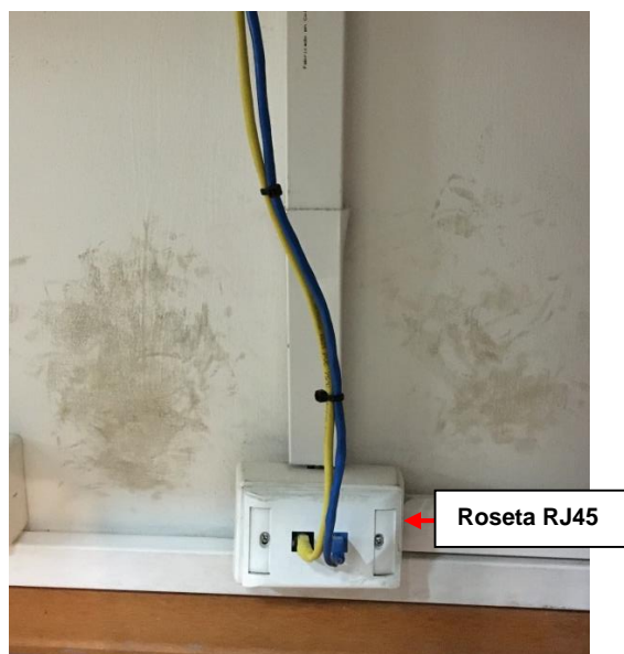
Figura 2.168. Roseta RJ45 para conexión en la red local de SEDEMI
