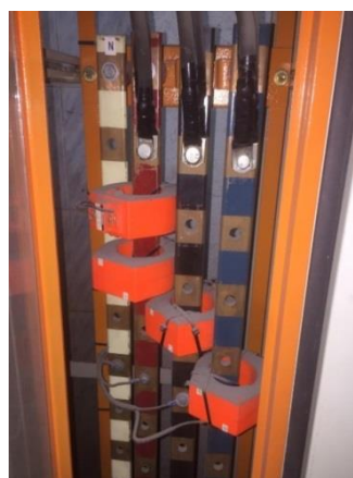
Figura 2.8. Transformadores de corriente CFS-63 Camsco instalados en las barras de la red 3Ø de 220V del área de Producción
