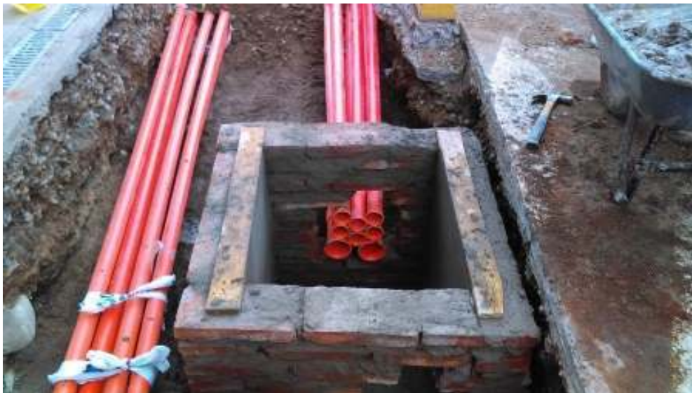
Figura 1.7. Pozo eléctrico en calzada – Obra civil para una red eléctrica subterránea de distribución [33]
