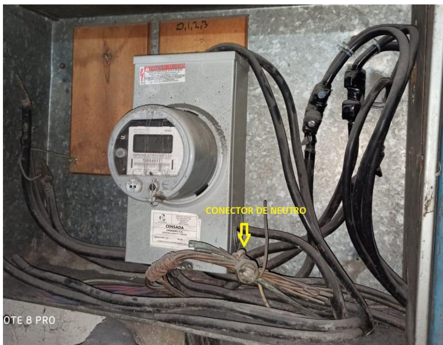
Figura 3.5. Medidor de energía
