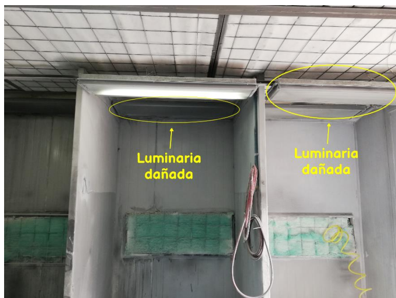
Figura 3.23. Iluminación cabina de pintura parte 2
