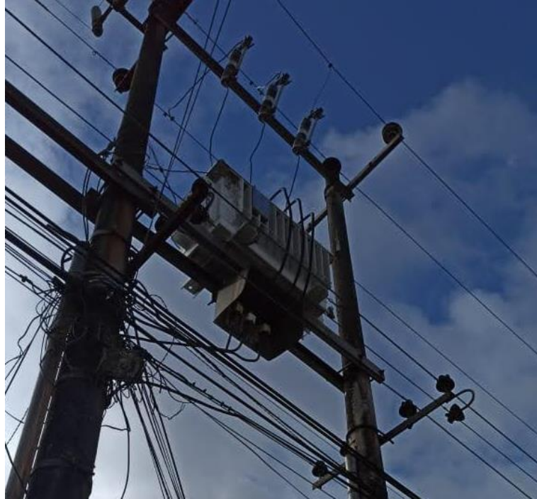
Figura 3.4. Transformador de distribución de la empresa WODEN S.A
