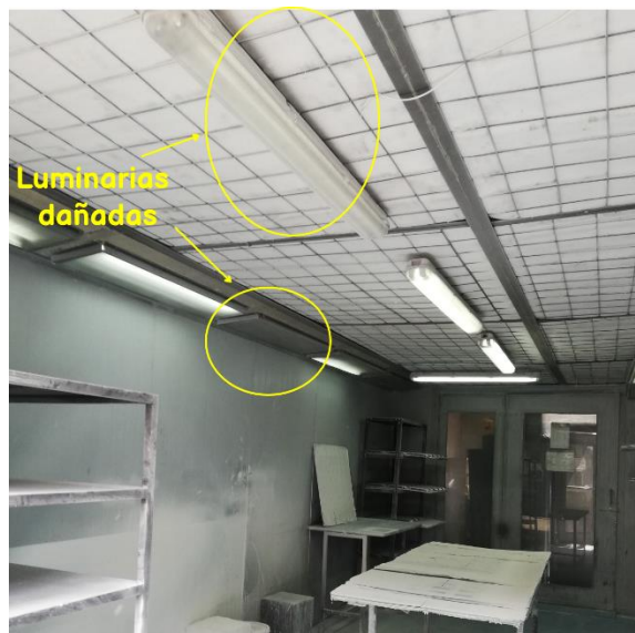
Figura 3.22. Iluminación cabina de pintura parte 1
