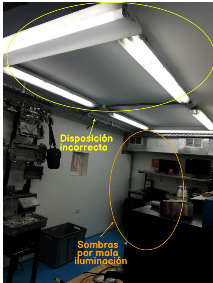
Figura 3.18. Iluminación área de pintura
