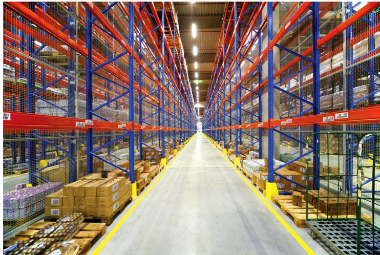
Figura 2.5. Lámparas fluorescentes en ambiente industrial [22]
