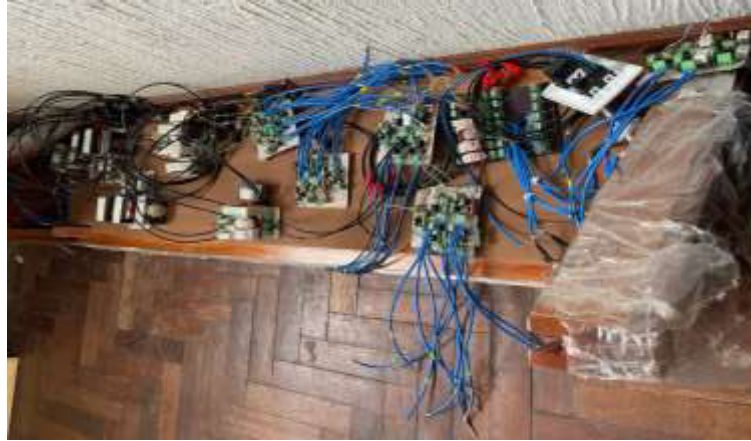
Figura M4. Ubicación de placas en el módulo y cableado de las mismas.
