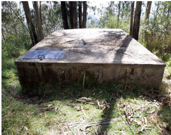
Figura 8. Tanque de almacenamiento de agua
