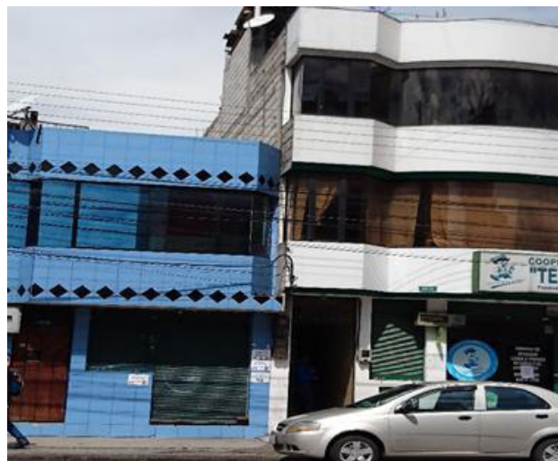
Figura 2-7 Construcciones Contiguas con presencia de Efecto de Martilleo Quito
