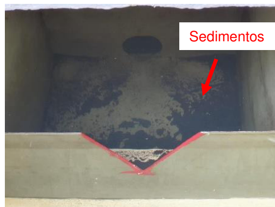
Ilustración 10: Vertedero triangular en el tanque sedimentador
