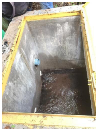
Ilustración 8 : Tanque de captación
