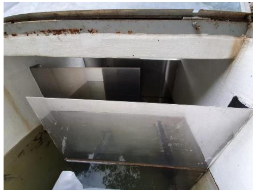
Ilustración 9 : Pantallas del tanque sedimentador
