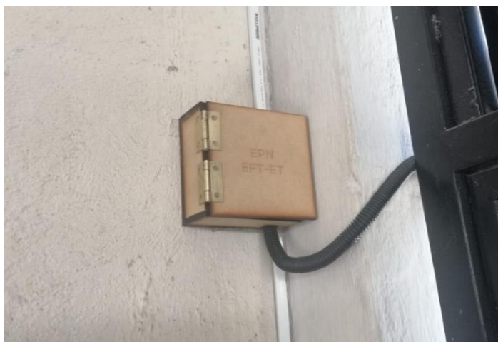
Figura 3.56 Módulo de control de acceso
