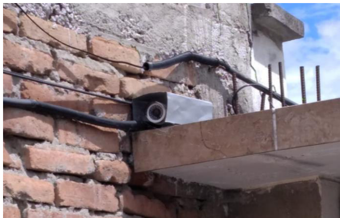
Figura 3.60 Cámara de Seguridad
