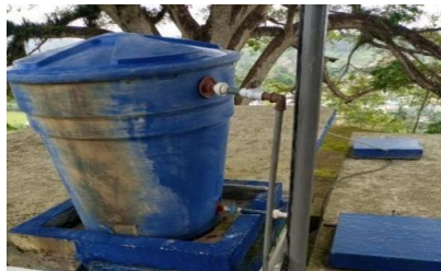
Figura 42 Hipoclorador por goteo
