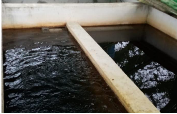
Figura 41 Tanque con la tubería perforada de filtración
