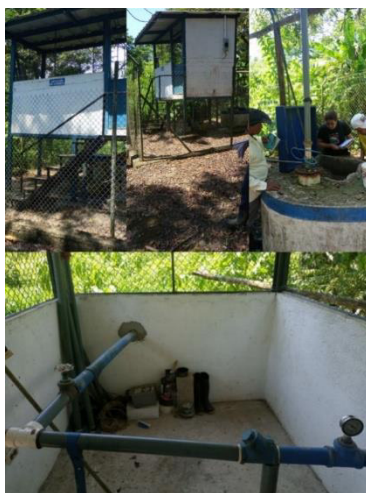
Figura 17 Estación de bombeo, parte externa e interna y pozo húmedo
