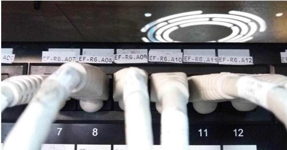
Figura 3.12 Etiquetado en el patch panel
