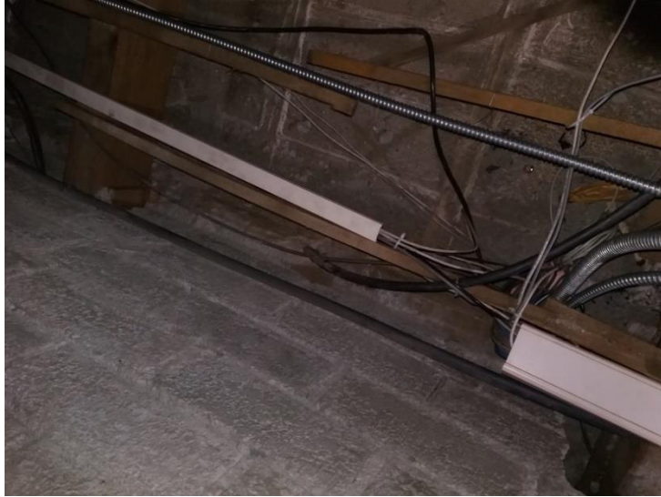
Figura 3.9 Canaletas a la salida del rack
