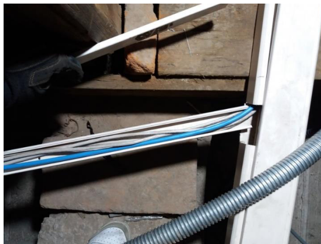
Figura 3.7 Derivación de cables por la canaleta secundaria
