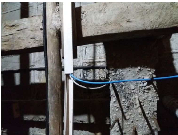
Figura 3.8 Derivación de cables a la oficina 9 y 10
