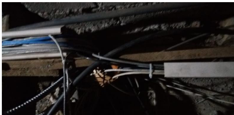
Figura 3.3 Canaletas a la salida del rack
