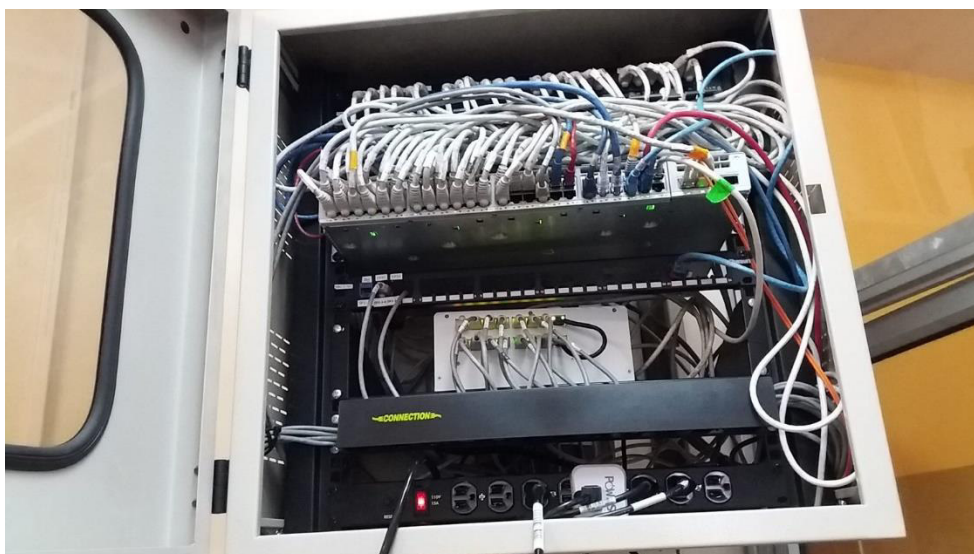
Figura 3.5 Elementos del rack
